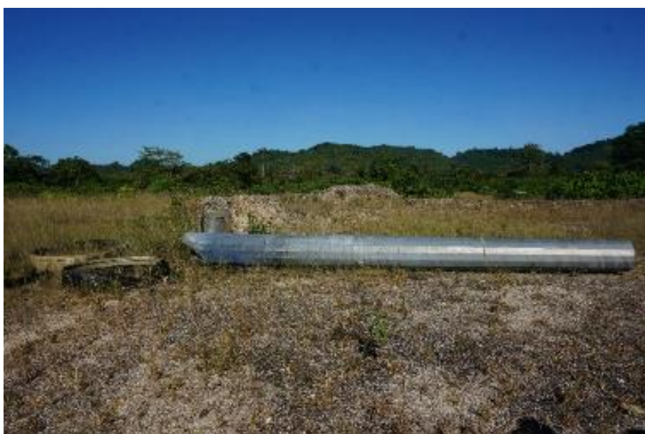
FOTOGRAFÍA No. 28 ESTRUCTURAS DE LA L/T CORTADAS.
