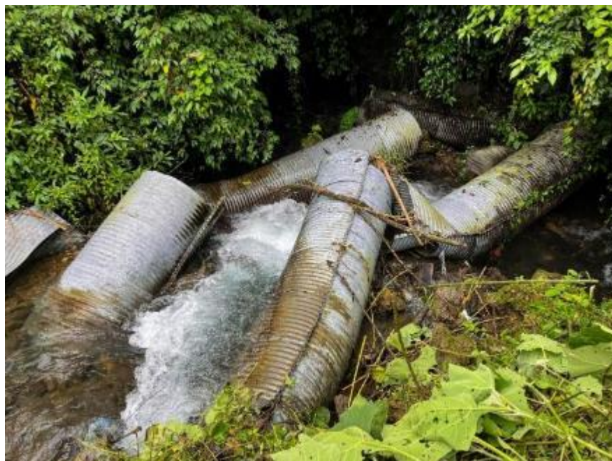
FOTOGRAFÍA No. 13 PRESENCIA DE TUBERÍA METÁLICA EN EL CAUCE DEL RÍO PRIMAVERA.
