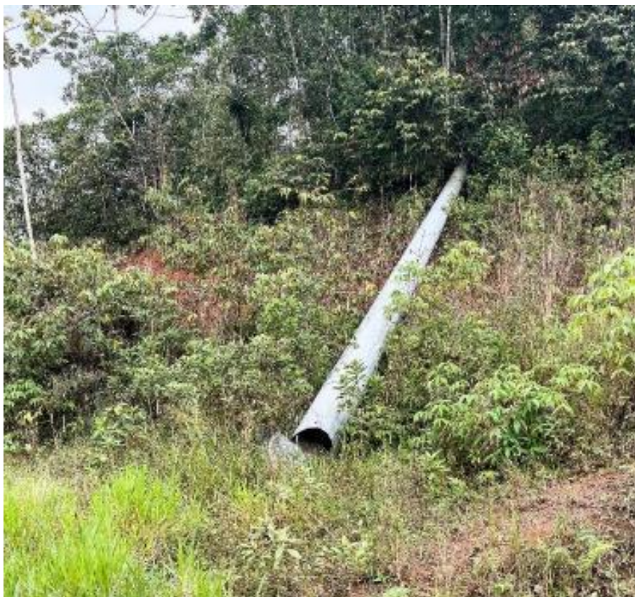
FOTOGRAFÍA No. 27 ESTRUCTURAS DE LA L/T CORTADAS.
