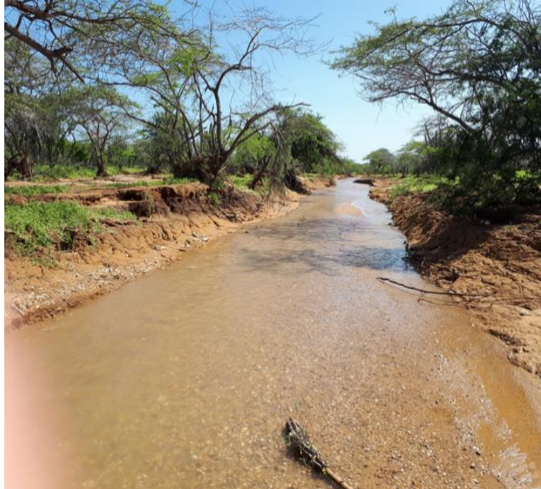
Foto 6-6. Suelos de génesis asociada a arroyos afectados por erosión hídrica e inundaciones en épocas de lluvias torrenciales
