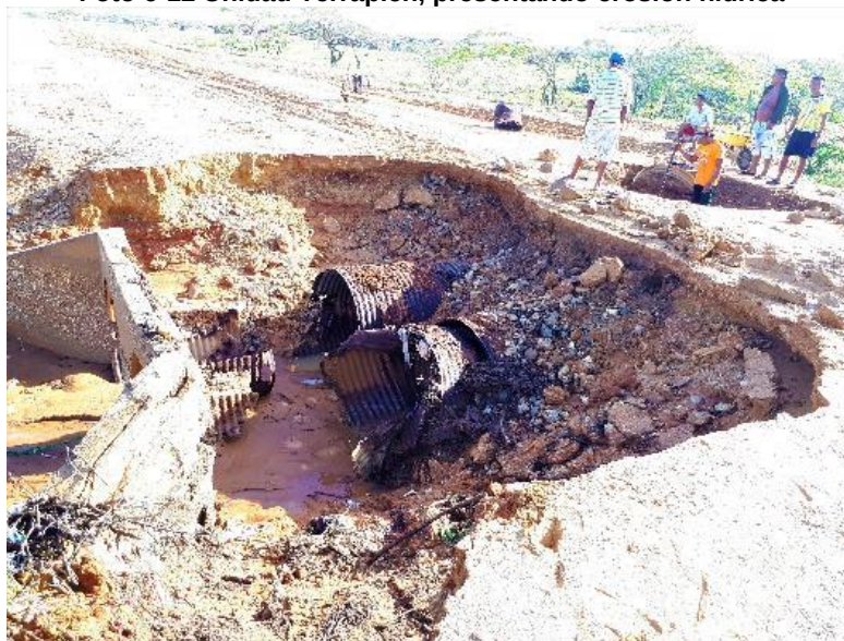
Foto 6-12 Unidad Terraplén, presentando erosión hídrica
