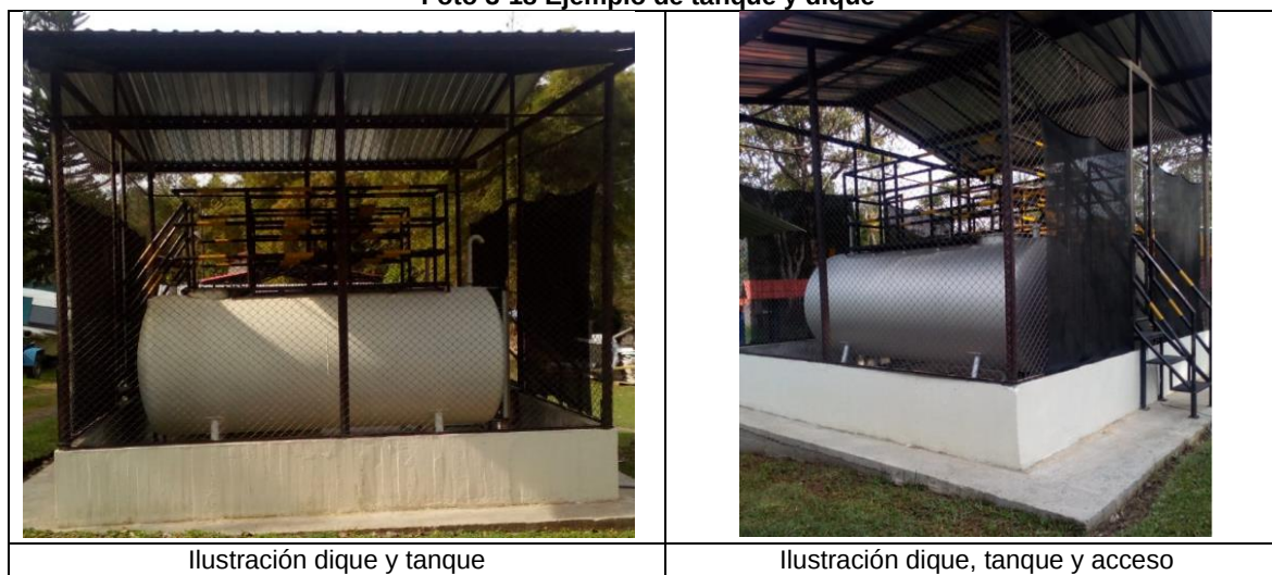
Foto 3-18 Ejemplo de tanque y dique
