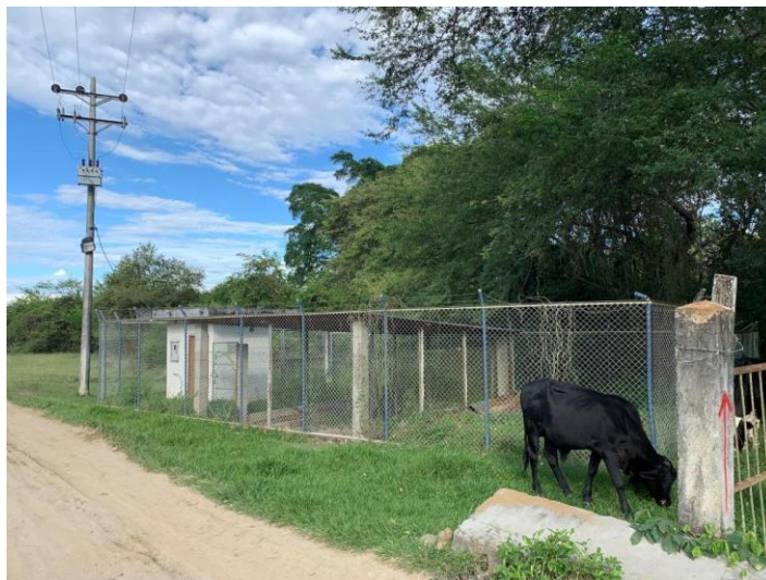
Foto 5.3-79 Red eléctrica y motobomba acueducto vereda Estación Doima
