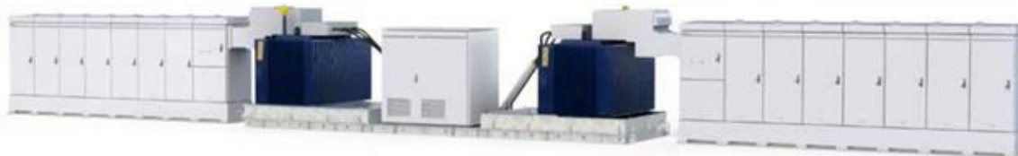
Figura 3.105. Estaciones de Media Tensión de dos inversores (tipo celdas a la intemperie).
