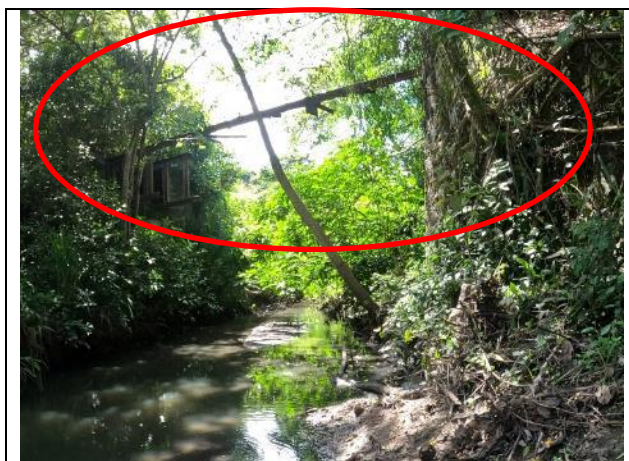
Fotografía 3.2-1 Estructura en desuso antigua línea férrea contigua a corredor Buenos Aires - Doima
