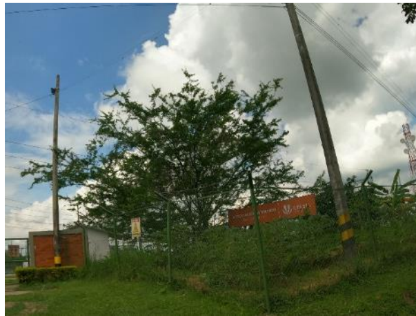
Fotografía 3.2-29 Subestación eléctrica Mirolindo
