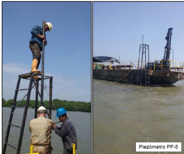
Fotografía No. 5.28. Piezómetro instalado en Mar. Fuente: EDIFICA COLOMBIA LTDA, en PIO S.A.S, 2015 181
