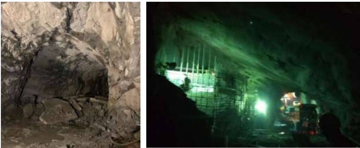
Figura n.º 2: Mecanismos de erosión y falla; cuñas y losas colapsadas desde el techo de los túneles
