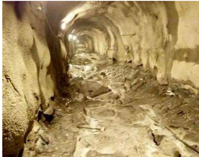
Figura n.º 4: Solera del túnel erosionada y destruida
