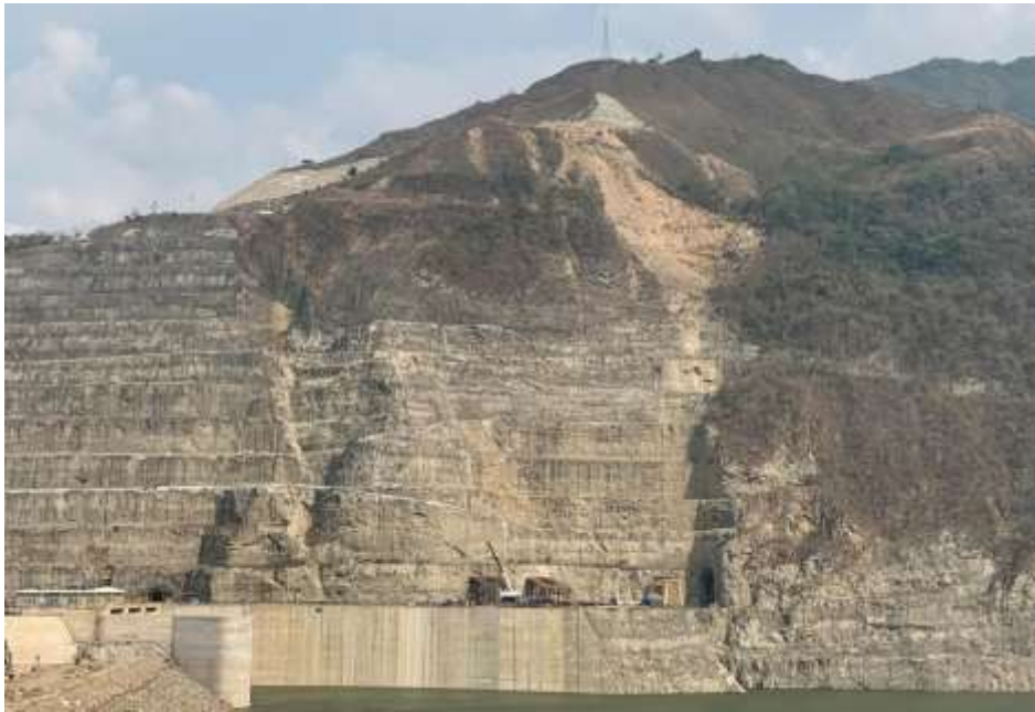
Figura n.º 12: Pendiente sobre las estructuras de entrada y trabajos de tratamiento iniciados cuesta arriba.
