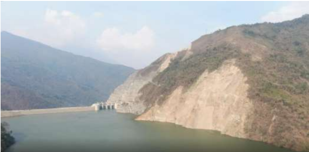
Figura n.º 14. El área desestabilizada por encima de los dos túneles de desvío. En el extremo superior, se aprecia la forma del desprendimiento de tierra en "El Romerito".
