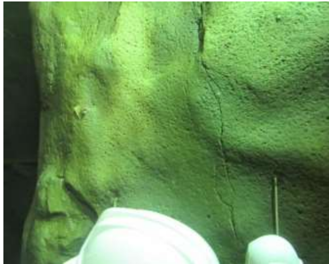
Figura n.º 3: Fisuras en la esquina del túnel de acceso en la entrada a la caverna de la casa de máquinas.
