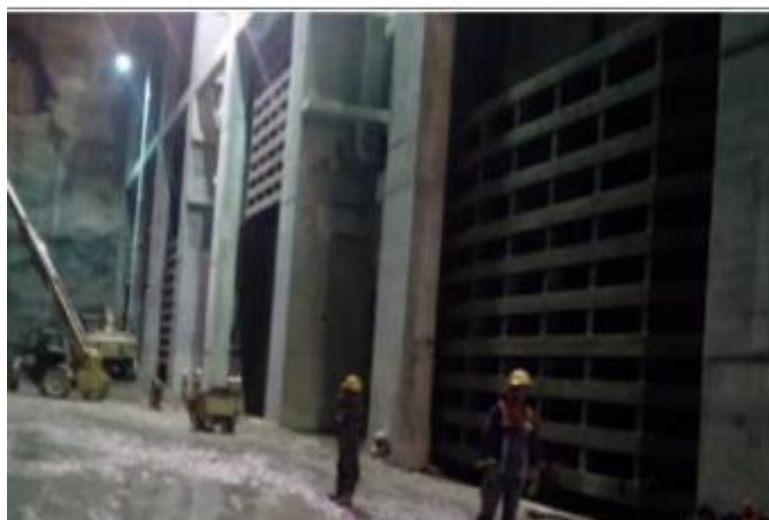
Figura 51: Compuertas de tubos de aspiración (archivo, fotografía tomada antes de mayo de 2018)
