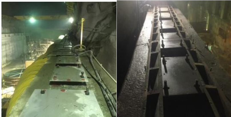
Figura 40: Instalación continua de soportes de rieles de grúas aéreas
