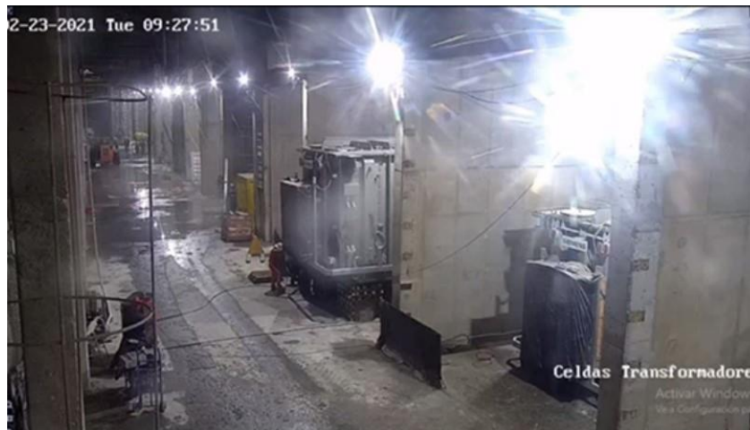
Figura 38: Dos transformadores monofásicos 3 y 4
