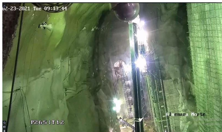
Figura 50: Instalación en curso de las guías de compuertas de tubos de aspiración en el pozo de carga norte
