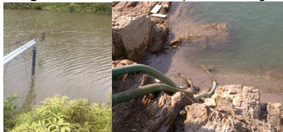
Fotografía 4-1 Sistema de captación de aguas.
