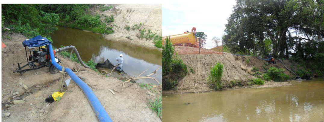
Fotografía 4-1 Sistema de captación de aguas.
