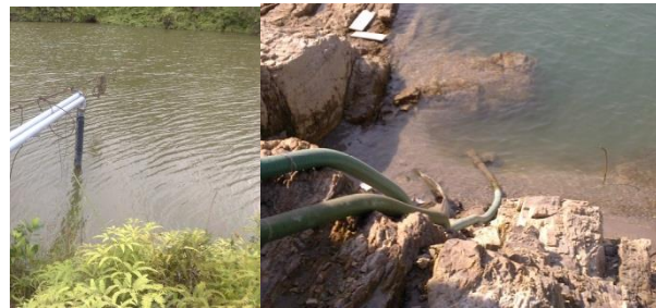
Fotografía 4-1 Sistema de captación de aguas.
