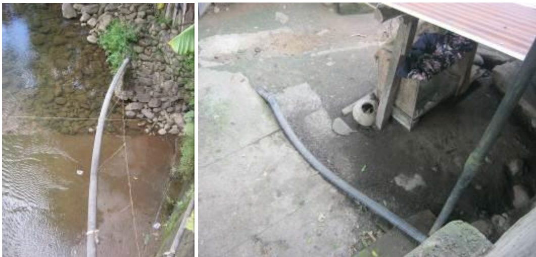
Fotografía 3-11 Tubería de acueducto en viviendas afectadas por la variante
