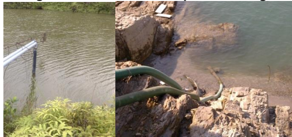
Fotografía 4-1 Sistema de captación de aguas.
