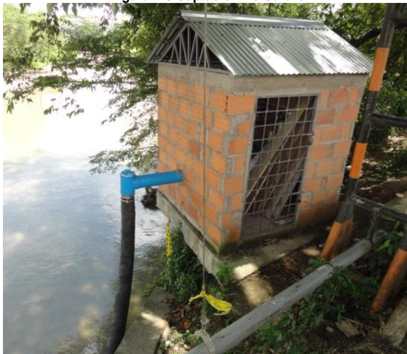
Figura 4-3 Captación río Carare
