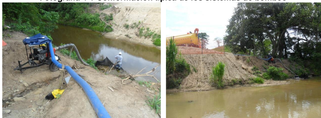
Fotografía 4-1 Conformación típica de los sistemas de bombeo
