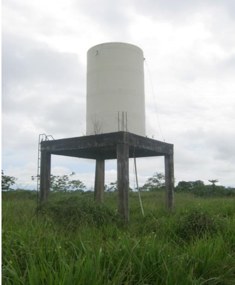
Fotografía 2-6 Tanque de almacenamiento de agua potable
