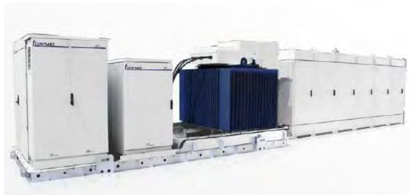
Figura 1.10.5.3-1. Centro de transformación.
