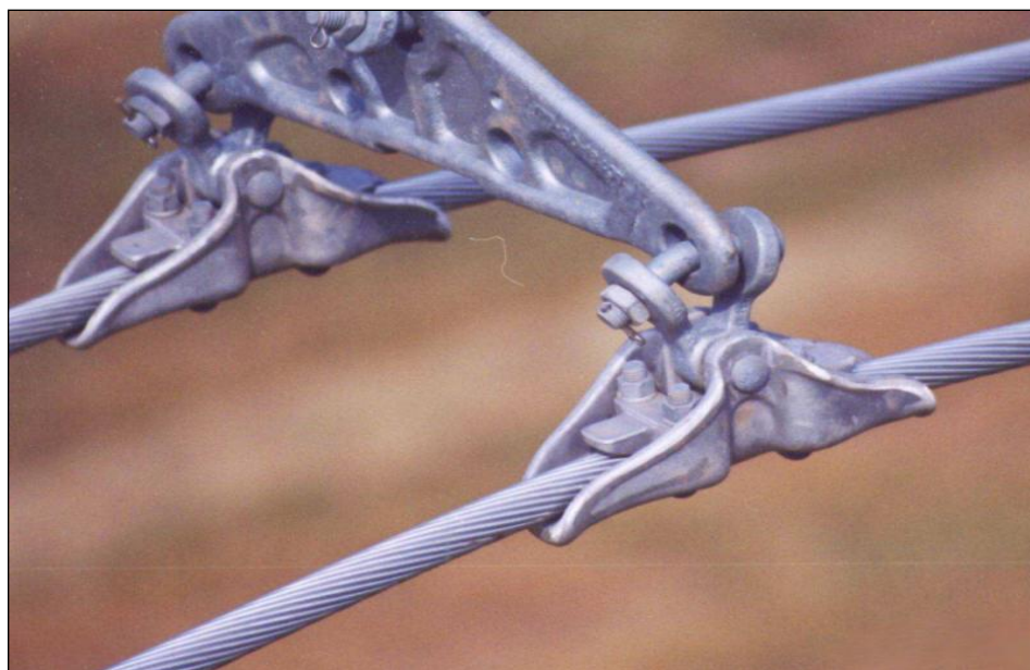
Vista del Conductor Sujetado en una torre de Suspensión
