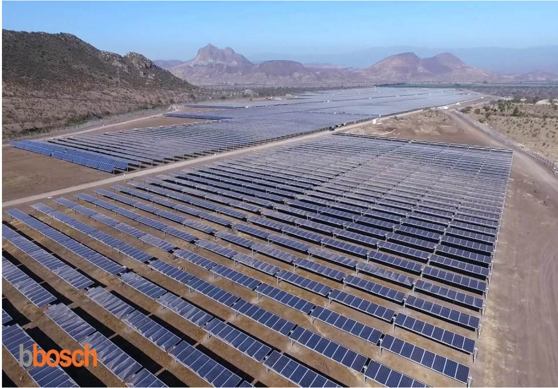
Vista de un proyecto Solar
