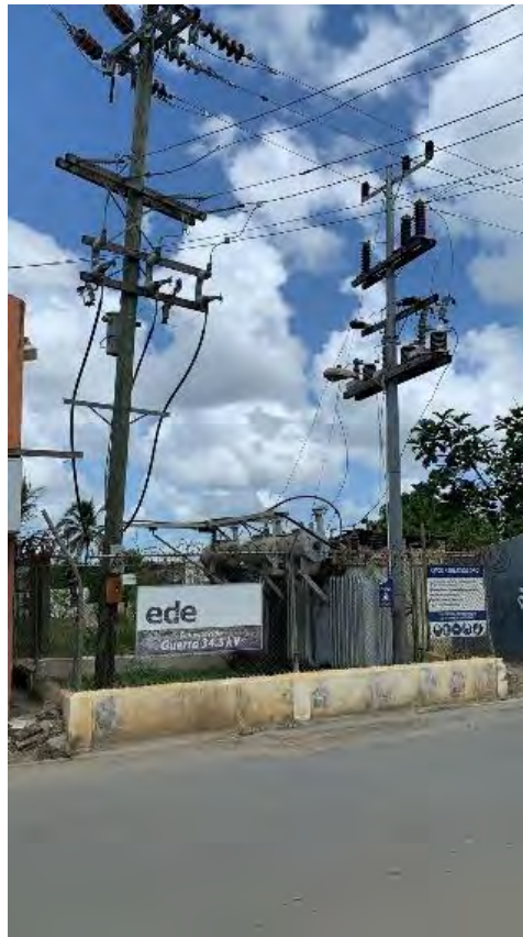
Foto 2.6.7.4-1. Subestación eléctrica de Guerra
