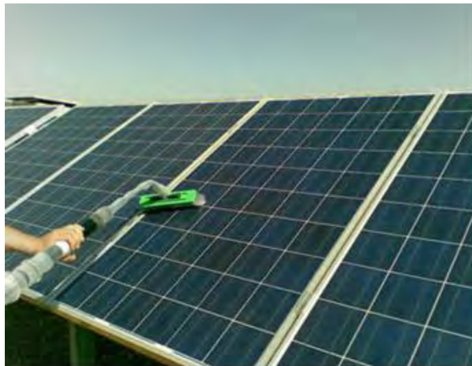
Foto 6.3.3-1. Forma de limpieza de los paneles solares.
