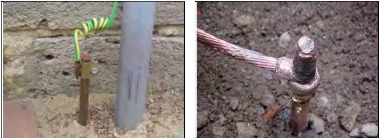
Fotos 6.5.4.1.3-1. Tipología de sistemas de aterramiento contra rayos (archivos de Empaca).
