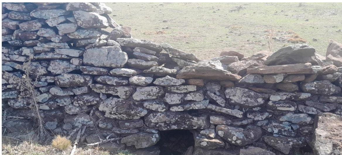
Figura 22: Setor colapsado, com projeção para a face interna. Note-se duto para escoamento de água, ação cautelar já prevista na concepção da murada, ante os rigores das chuvas.
