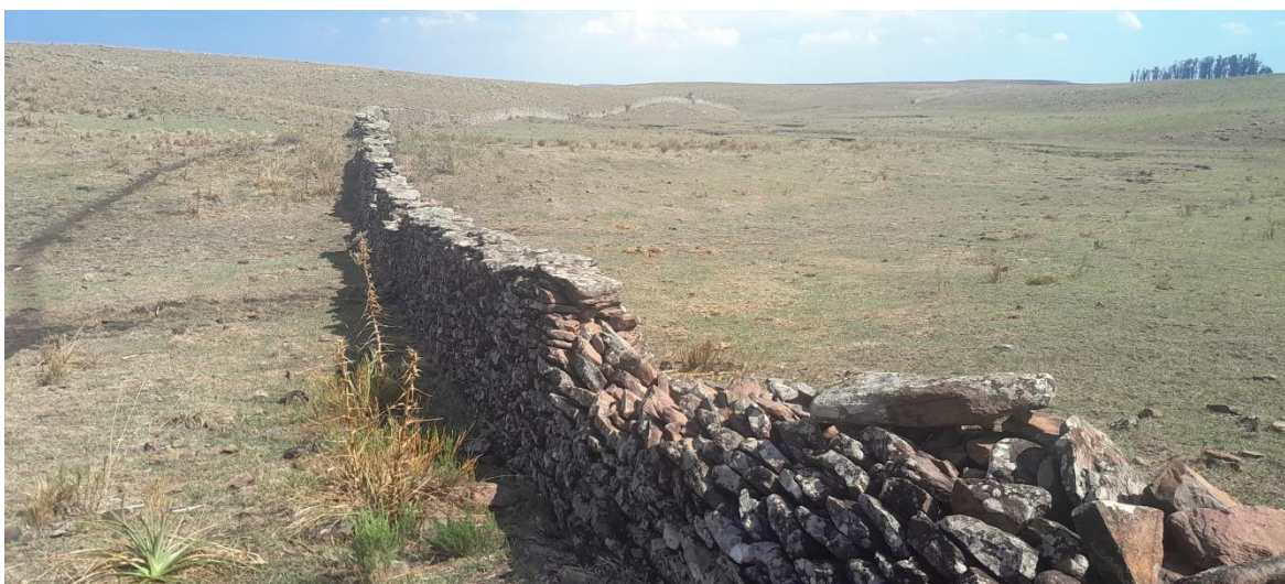
Figura 20: Setor colapsado, com projeção para a face interna.
