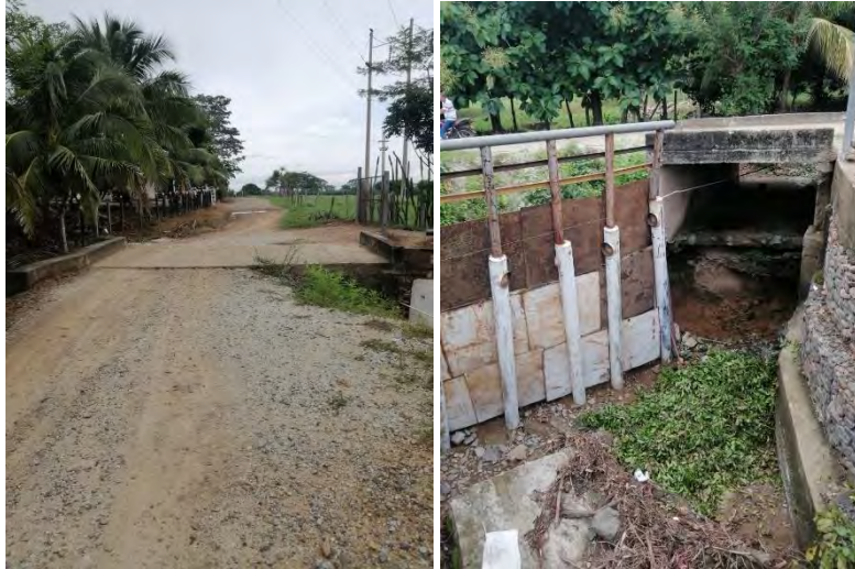
Figura 76 Puente sobre la vía de acceso a existente que requiere intervención
