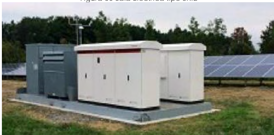
Figura 50 Sala Eléctrica tipo SKID
