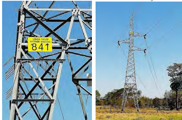
Figura 22 Redes Eléctricas de Alta tensión Buturama – Ayacucho -115 kV.
