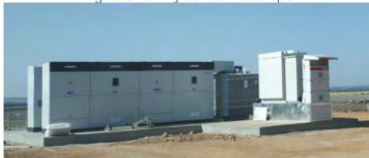
Figura 52 CTIN y transformador tipo
