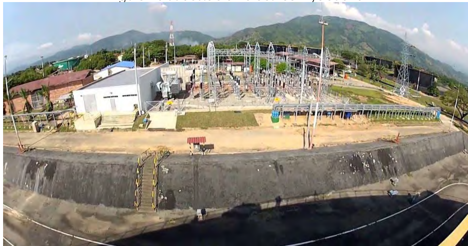
Figura 20 Subestación eléctrica Ayacucho.
