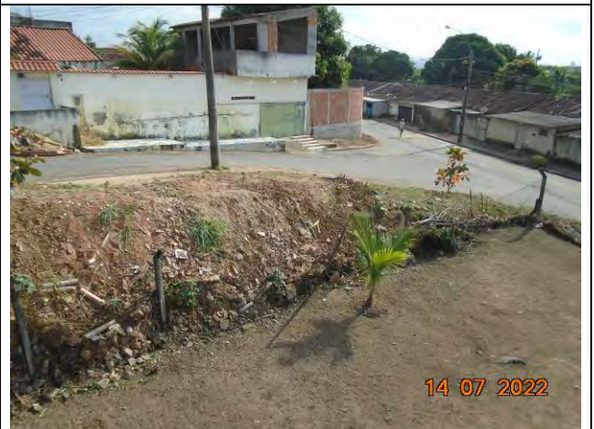
Foto 28: Cercamento deteriorado da área da Unidade.
