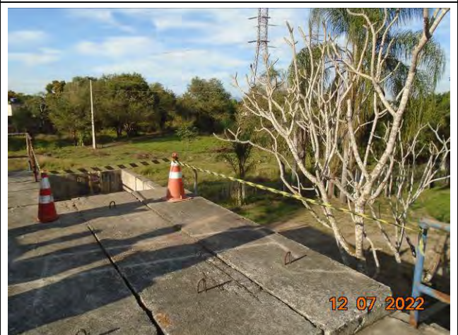
Foto 06: Detalhe da ausência de guarda-corpo na parte superior da ETE.
