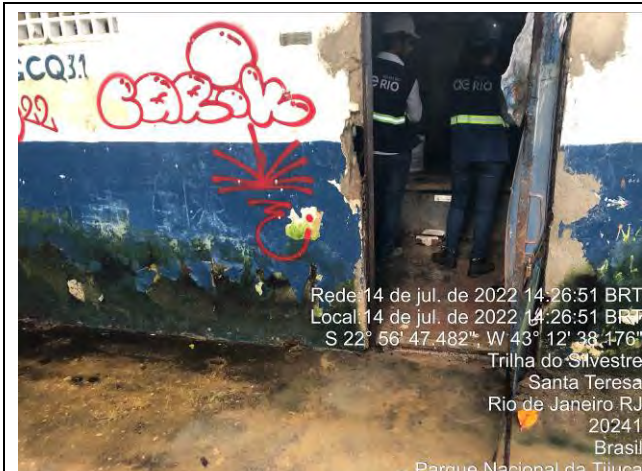
Foto 35: Registro da área de cloração da UT Paineiras. Nota-se que a estrutura está danificada.
