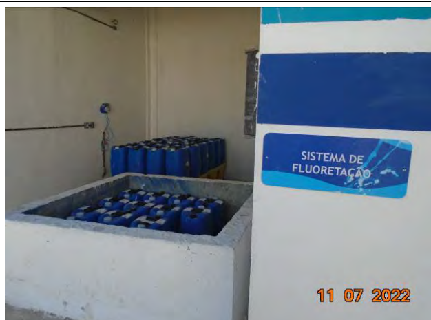
Foto 05: Armazenamento dos produtos utilizados no tratamento da água.
