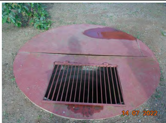
Foto 11: Gradeamento de entrada do efluente na unidade.
