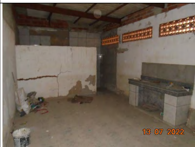
Foto 36: Copa da área administrativa que está em desuso.
