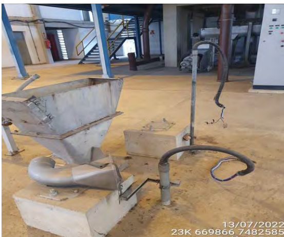
Foto 03: Detalhe de equipamentos obsoletos e com fios desencapados.
