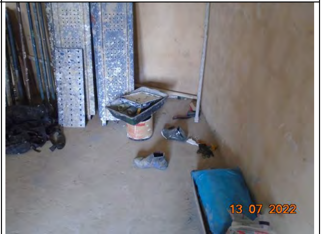
Foto 40: Uma das salas da área administrativa que está em desuso. Nota-se a presença de resíduos de construção civil (andaimes, ripas de madeira e mangueiras) e EPIs.
