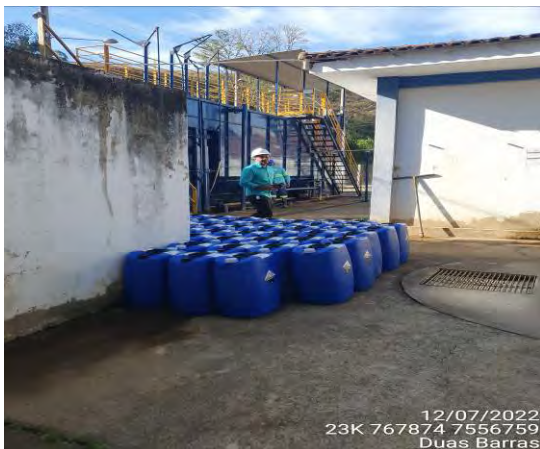
Foto 13: Vista dos produtos químicos dispostos de forma irregular, sem bacia de contenção, sem sinalização e sem extintor na área.
