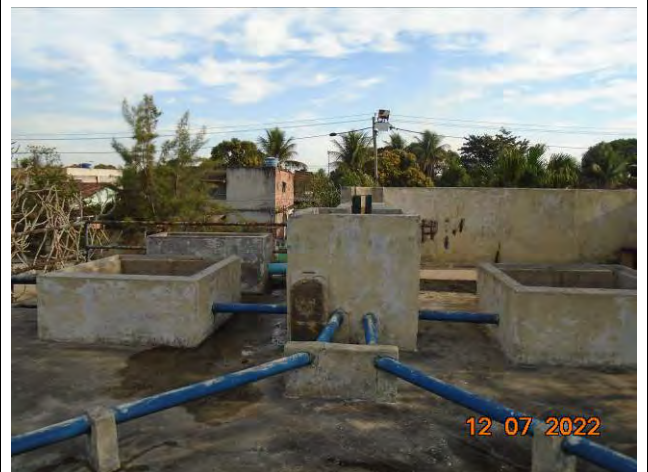
Foto 04: Visão geral da parte superior da ETE.
