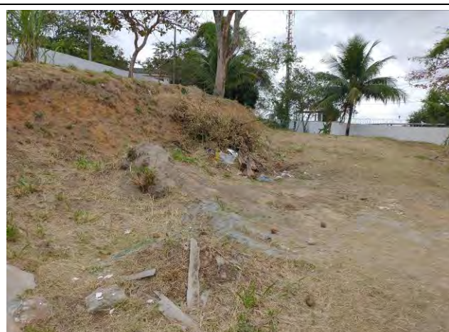
Foto 06: Área externa do prédio administrativo (área com barranco exposto – outro ângulo).
