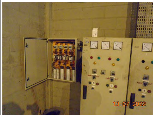
Foto 17: Painéis localizados dentro da sala de bombas – foto aproximada.
