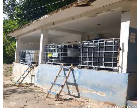
Foto 032: Casa de armazenamento de cloro na estrada de acesso, sem portaria, a estação de tratamento.
