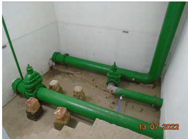
Foto 07: Tubulação de entrada da água tratada.
