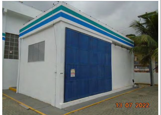
Foto 16: Sala de força devidamente fechada com cadeado para controle de acesso.
