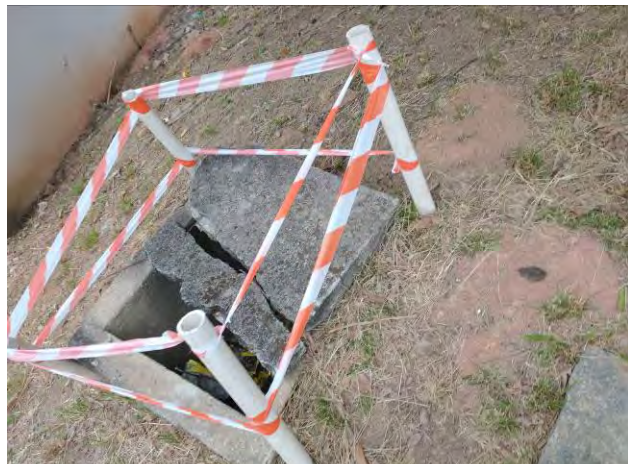
Foto 19: Área com risco de queda.
