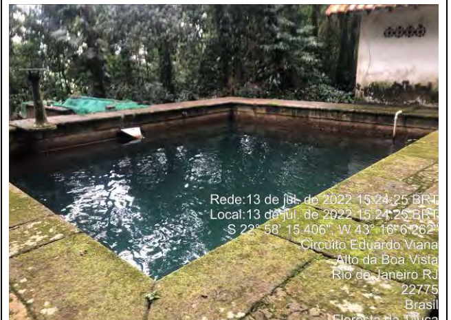
Foto 20: Vista geral da caixa 1 de tratamento da UT Gávea. Nota-se a falta de cobertura e sinalização na área.
