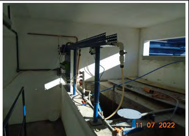
Foto 24: Resíduos de obras em andamento na área do dosador de sulfato de alumínio ferroso (outro ângulo).
