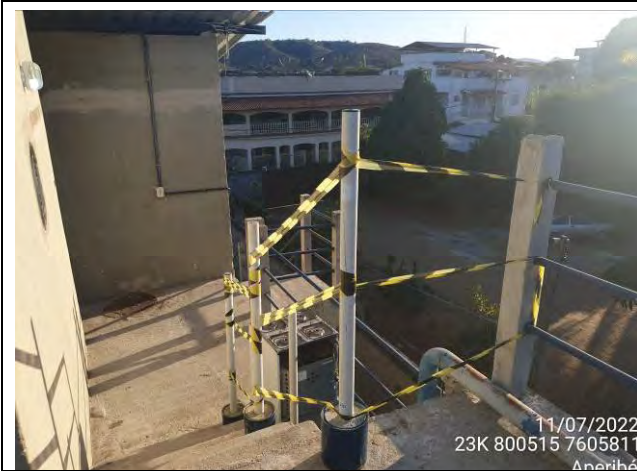
Foto 07: Vista da escada sem guarda-corpo.
