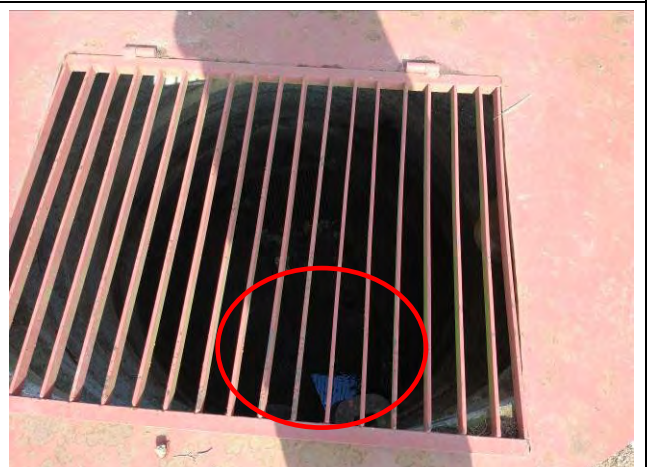
Foto 12: Gradeamento de entrada do efluente na unidade, com resíduos retidos.
