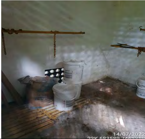
Foto 41: Vista geral da área de armazenamento de produtos químicos. Nota-se que estão armazenados de forma incorreta, sem sinalização, sem FISPQ e sem extintor na área.
