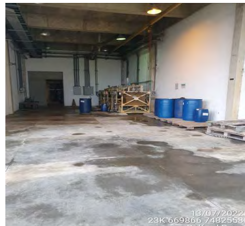
Foto 02: Detalhe da área de armazenamento de produtos químicos de forma irregular.
