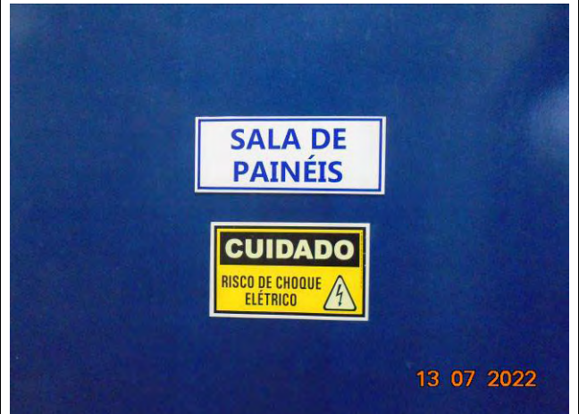
Foto 10: Sinalização da entrada da sala de painéis.
