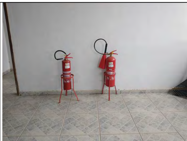
Foto 32: Extintores na área de convivência.
