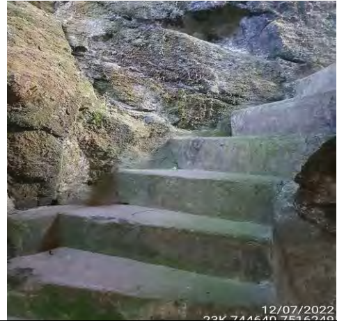
Foto 02: Vista da escada para acesso a coleta. Nota-se que a escada não possui guarda-corpo e sinalização.
