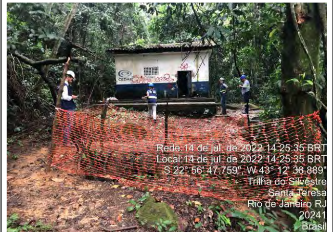
Foto 34: Registro da UT Paineiras. Nota-se que a estrutura está obsoleta.
