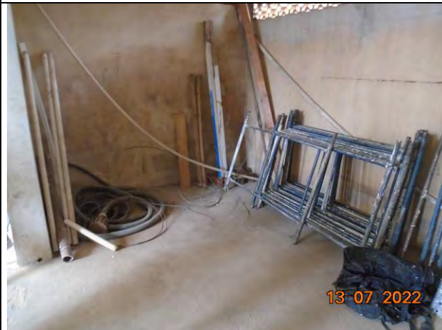
Foto 39: Uma das salas da área administrativa que está em desuso. Nota-se a presença de resíduos de construção civil (andaimes, ripas de madeira e mangueiras)
