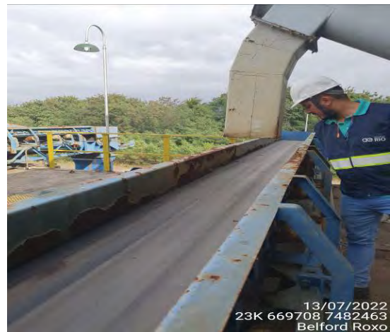
Foto 10: Registro dos equipamentos e da esteira na ETE necessitando de manutenção e obsoletas.
