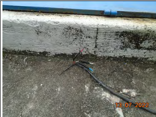
Foto 13: Detalhe de fiação exposta.
