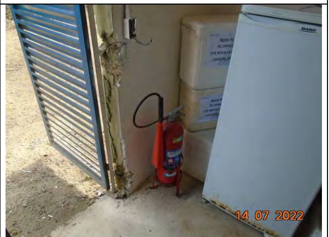
Foto 24: Fiação exposta e problemas estruturais no batente da porta da sala de análises de qualidade do efluente.
