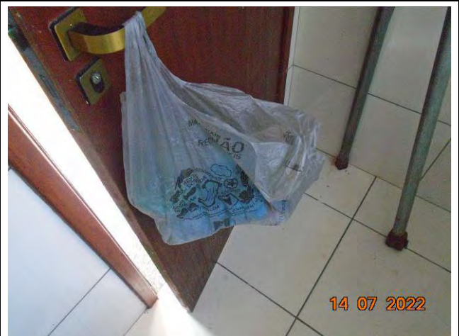
Foto 10: Detalhe da ausência de lixeira para armazenamento temporário de resíduos. Observou-se que os resíduos estavam sendo dispostos em sacolas plásticas.
