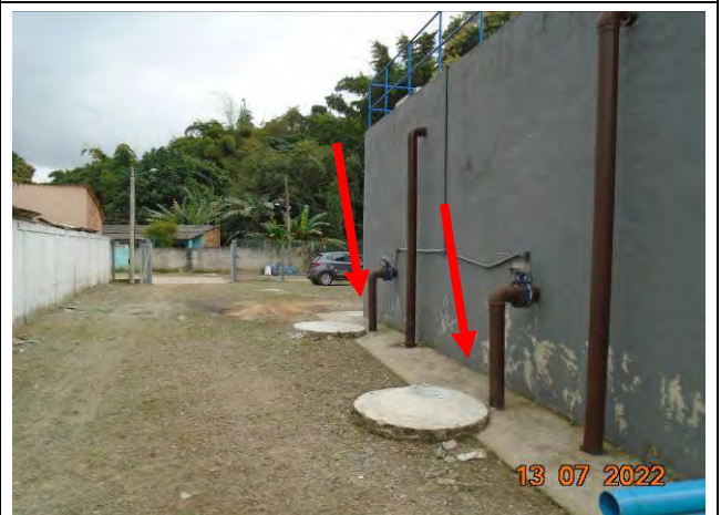
Foto 06: Saída do efluente tratado – ao fundo da imagem localiza-se o portão de acesso da ETE.
