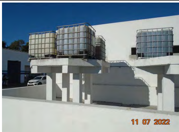
Foto 09: Tanques de sulfato de alumínio ferroso que estão conectados ao sistema de tratamento para gotejamento automático.
