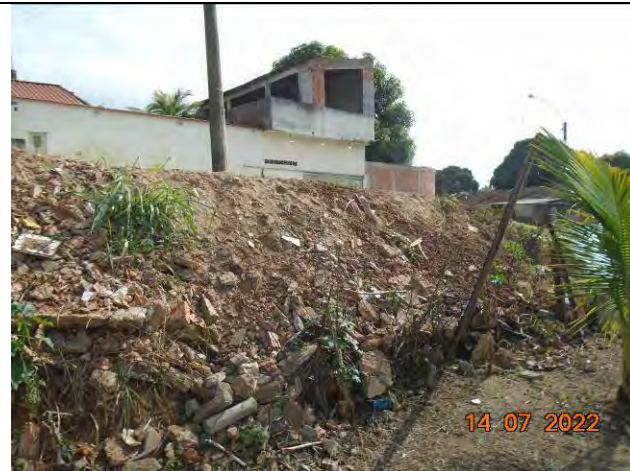
Foto 31: Cercamento deteriorado da área da Unidade.
