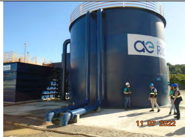
Foto 25: Reservatório de água bruta
