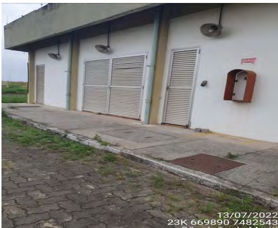
Foto 01: Vista geral da subestação da ETE. Nota-se a falta de sinalização e extintores de incêndio.
