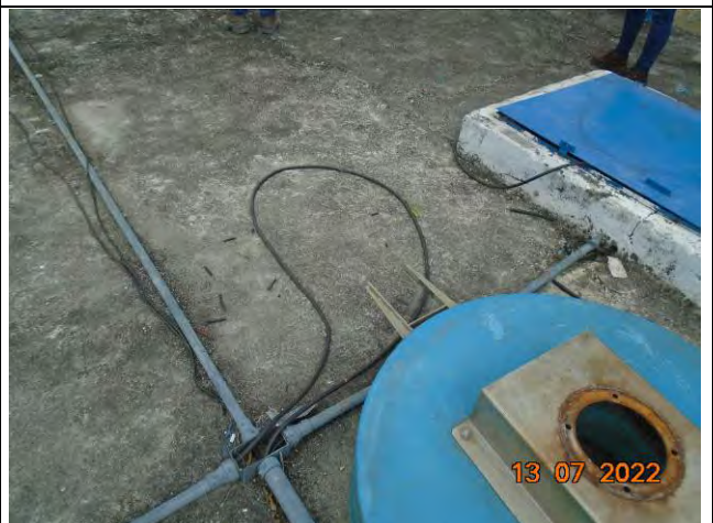
Foto 12: Fiação exposta e má conservação das estruturas.
