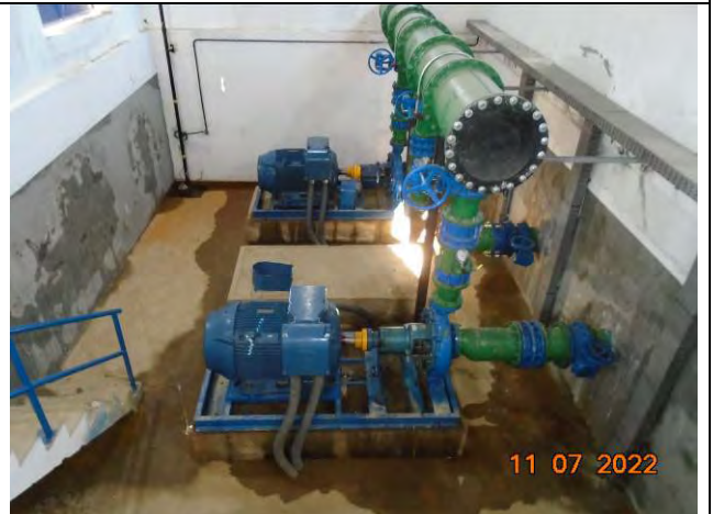
Foto 28: Casa de máquina - elevatória de água tratada (outro ângulo).
