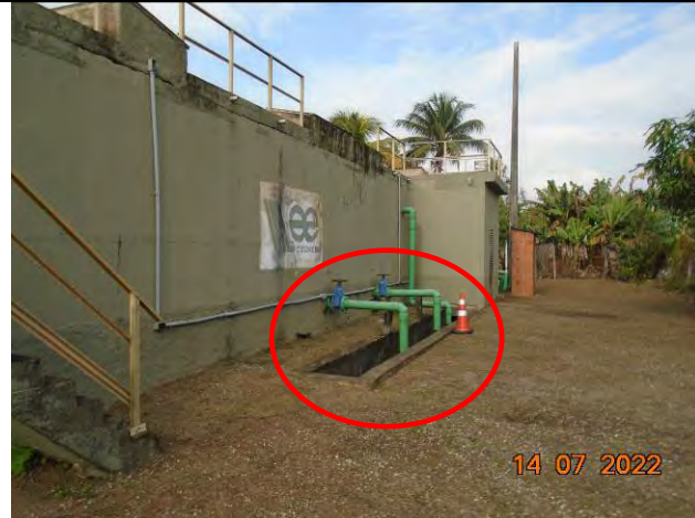
Foto 19: Saída do efluente tratado.
