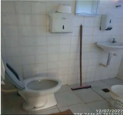
Foto 13: Vista do banheiro do operador. Nota-se a falta de lixo.
