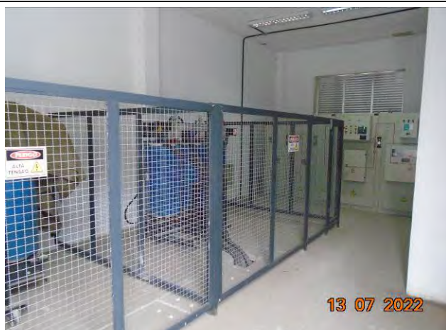
Foto 17: Interior da sala de força
