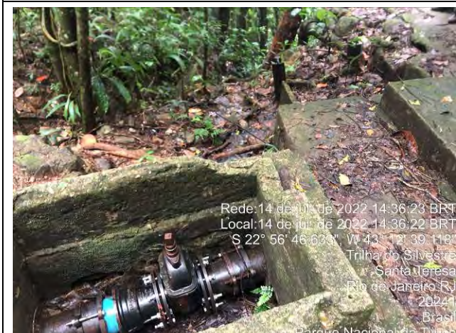
Foto 39: Registro da tubulação na UT Paineiras. Nota-se que a área não tem nenhuma sinalização.
