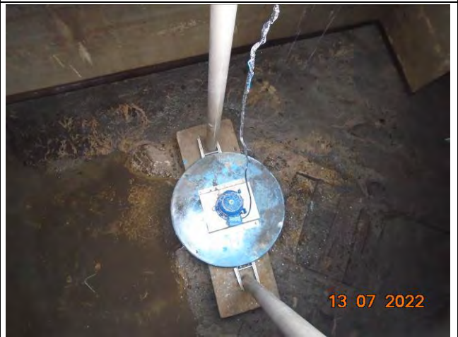
Foto 10: Bomba desativada de uma das caixas.
