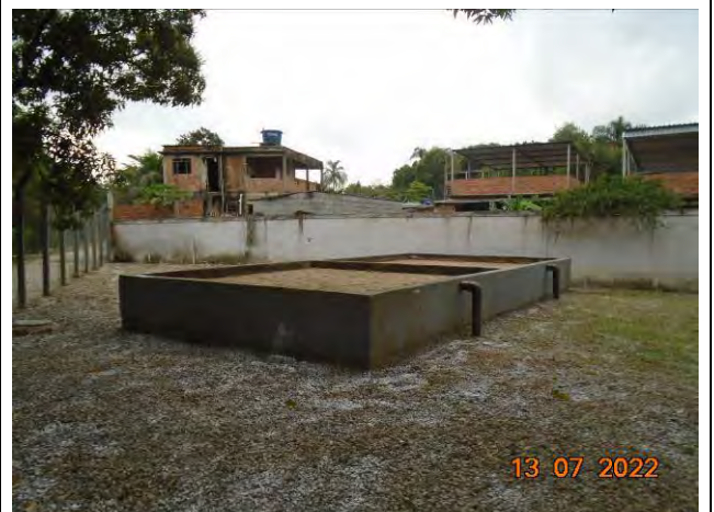
Foto 02: Tanques para secagem do lodo residual do tratamento.
