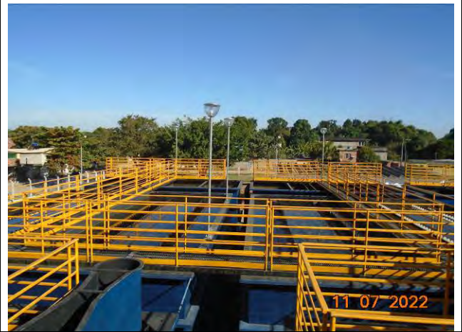
Foto 02: Vista geral dos conjuntos de tratamento da ETA Magé (outro ângulo).
