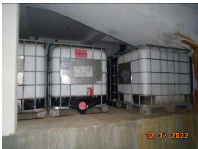
Foto 23: Local para acondicionamento do cloro utilizado no sistema de tratamento.
