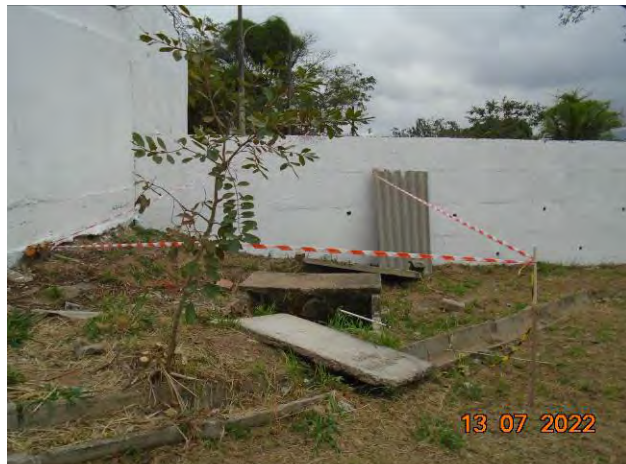
Foto 13: Área externa do prédio administrativo (resíduo de construção civil e sinalização de área de risco de queda).
