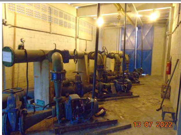
Foto 11: Casa de bombas – outro ângulo.
