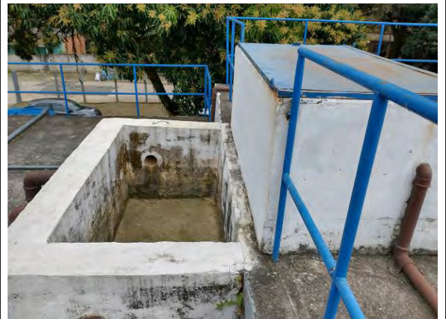
Foto 08: Caixa de decantação.
