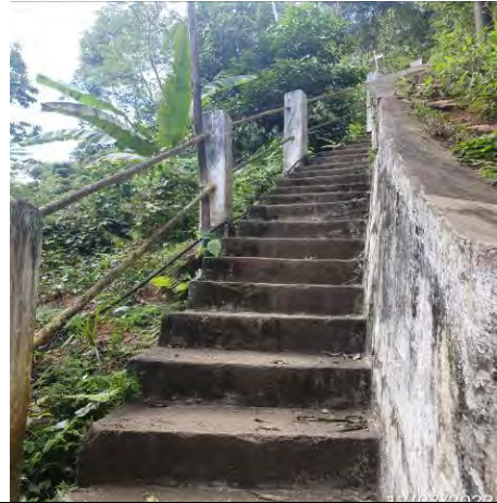
Foto 14: Registro da escada que operador utiliza para sair da EEAT. Nota-se a falta de sinalização e precisando de manutenção.
