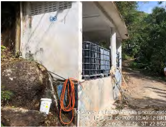
Foto 031: Casa de armazenamento de cloro na estrada de acesso, sem portaria, a estação de tratamento.
