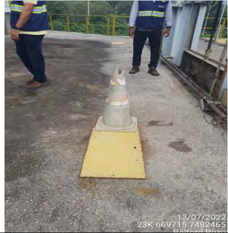
Foto 8: Registro de buraco na ETE e coberta com um cone.
