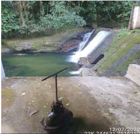
Foto 03: Vista da barragem. Nota-se equipamento obsoleto.
