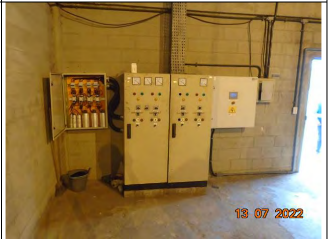
Foto 16: Painéis localizados dentro da sala de bombas.
