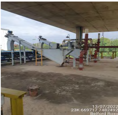
Foto 03: Detalhe do aparelho ciclone na ETE. Um dos aparelhos não podia ser utilizado, pois estava quebrado.
