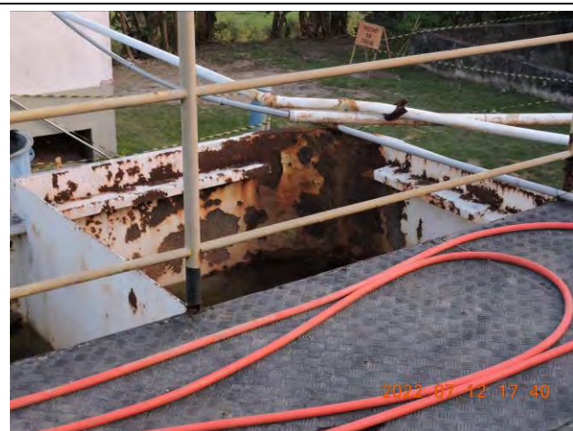
Foto 21: Pontos de corrosão na parte interior dos tanques de decantação.
