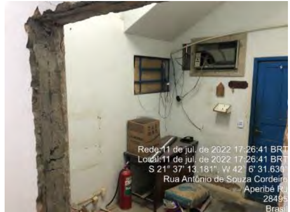
Foto 10: Local em reforma para novo local de copa para utilização dos trabalhadores.
