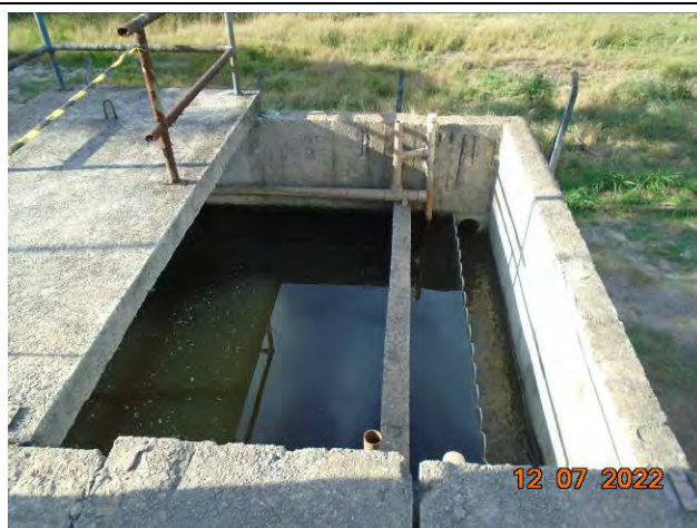
Foto 05: Vista geral do tanque de aerção sem cobertura e da ausência de guarda-corpo no entorno do local.
