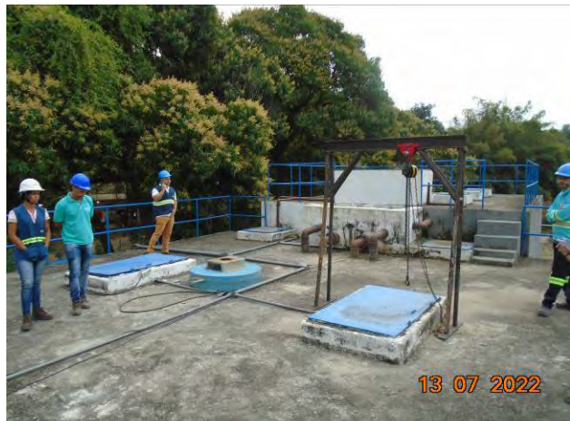
Foto 07: Vista geral da parte superior da ETE – caixas de areia, decantação, batelada.
