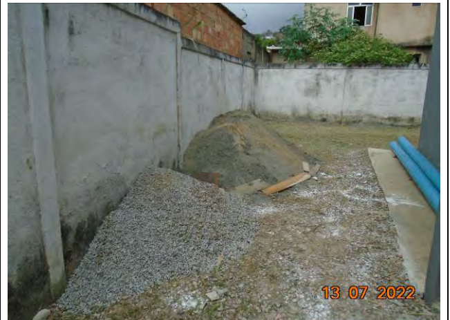
Foto 04: Resíduos de construção civil no terreno da ETE.
