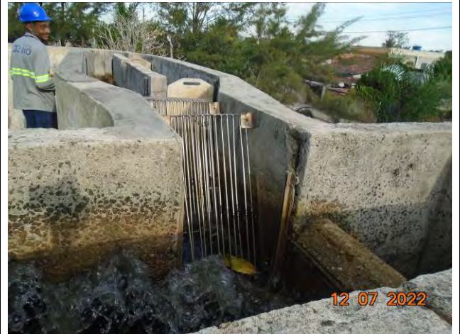
Foto 02: Detalhe do gradeamento na entrada do efluente na ETE.
