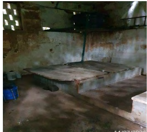
Foto 44: Vista da área de cloração da UT Paineiras. Nota-se que a área necessita de reforma e manutenção.
