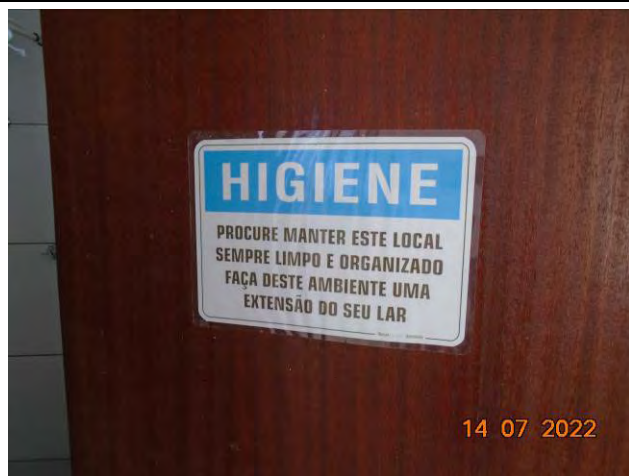
Foto 11: Detalhe da sinalização no sanitário.
