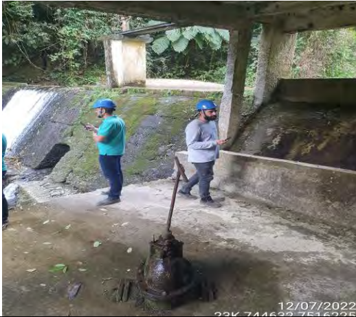
Foto 01: Registro da barragem. Nota-se equipamentos obsoletos.
