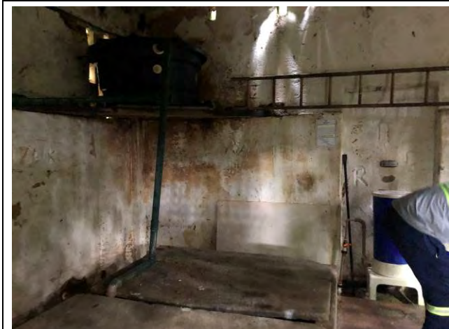
Foto 37: Registro da área de cloração. Nota-se que a área necessita de manutenção.
