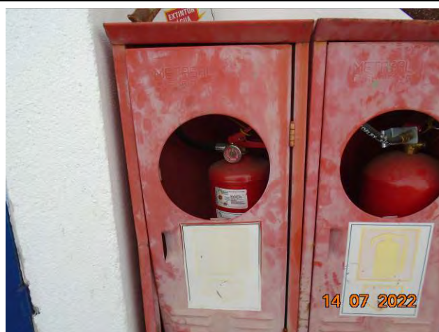
Foto 05: Detalhe dos extintores de incêndio (ambos dentro do prazo de validade).
