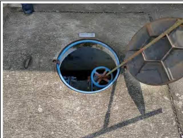
Foto 19: Detalhe do registro de manobra na ERES Taça.
