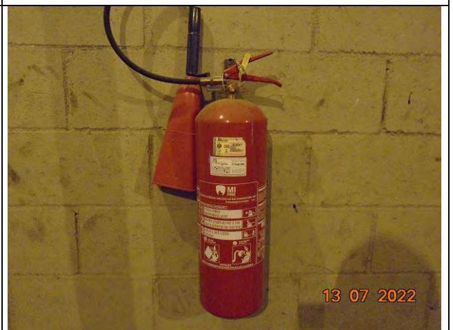
Foto 18: Extintor localizado dentro da sala de bombas.
