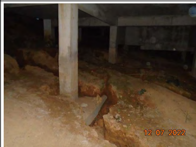
Foto 24: Detalhe de feições erosivas sob o reservatório com capacidade de 1 milhão de litros.
