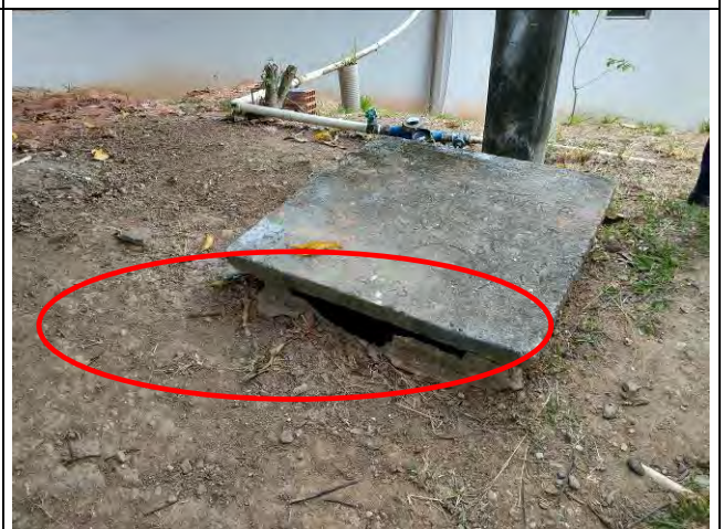
Foto 48: Parte de estrutura de drenagem rompida.
