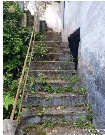
Foto 12: Vista da escada para acesso a EEAT, necessitando de manutenção.
