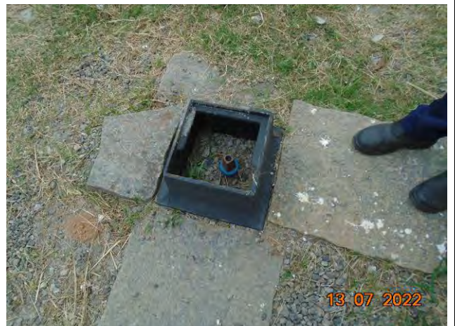
Foto 10: Detalhe do local da chave para realização de manobras.
