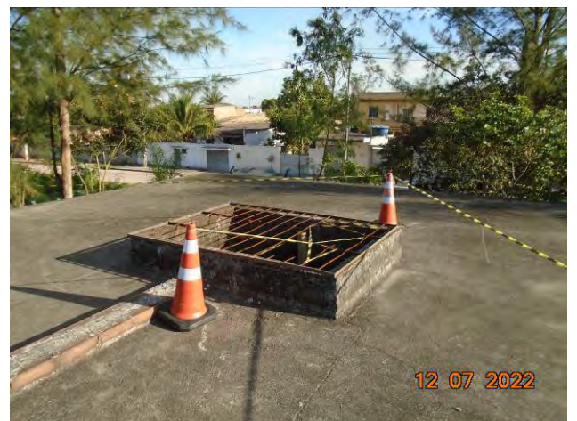
Foto 12: Detalhe da ausência de guarda-corpo e da grade de proteção danificada na parte superior do sistema de tratamento por batelada.
