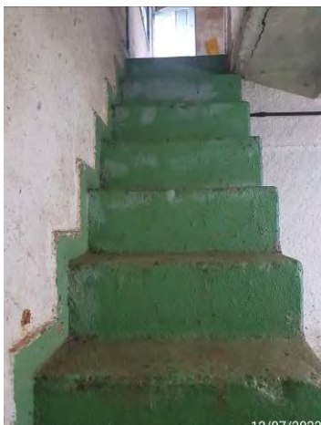
Foto 05: Registro da escada para a casa de cloração, sem guarda-corpo, sinalização e precisando de manutenção.
