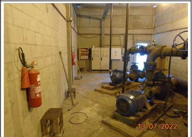
Foto 12: Casa de bombas – outro ângulo.
