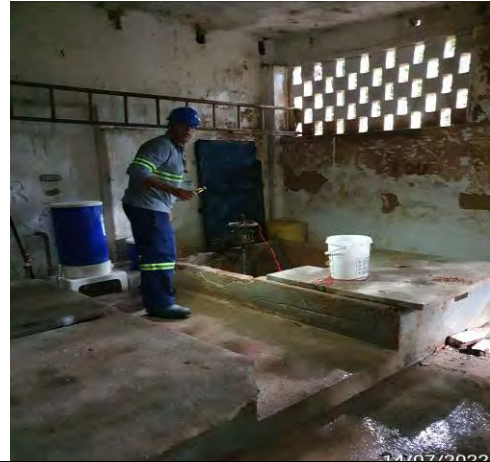
Foto 42: Detalhe da área de cloração. Nota-se que a área necessita de manutenção e reformas.
