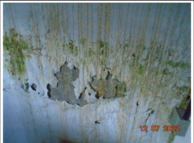
Foto 18: Detalhe de mofo nas paredes do laboratório e sala de fluoração.
