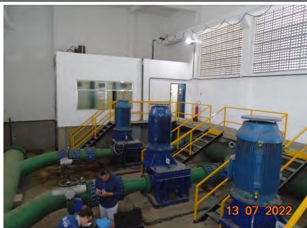
Foto 05: Conjunto de bombas – vista geral, outro ângulo.
