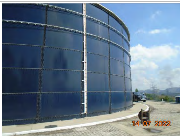
Foto 03: Detalhe da régua para monitoramento do nível do reservatório.
