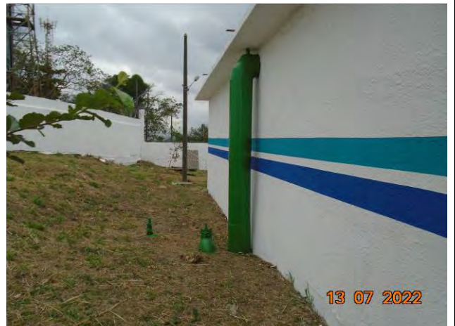
Foto 08: Tubulação de entrada da água para o reservatório.
