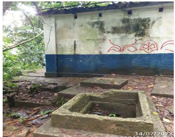
Foto 46: Vista da área da UT sem guarda-corpo, sem sinalização.
