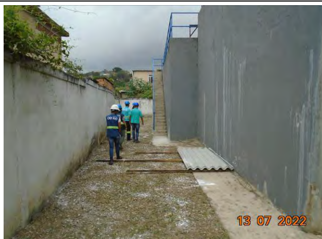
Foto 05: Resíduos de construção civil no terreno da ETE – vista lateral da unidade.
