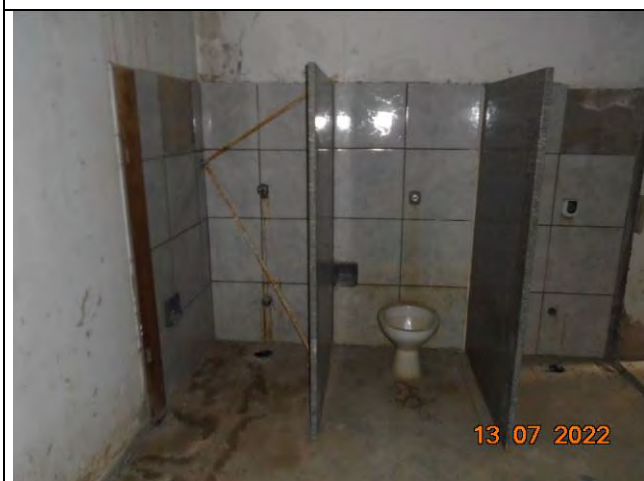
Foto 35: Banheiro e vestiário da área administrativa que está em desuso.
