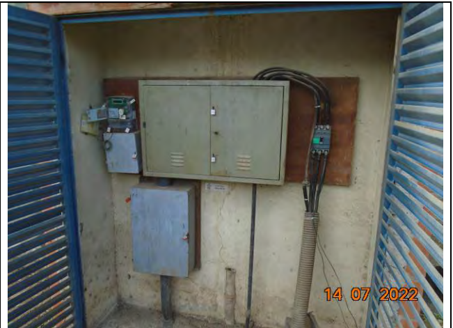
Foto 26: Interior da caixa de força da Unidade.
