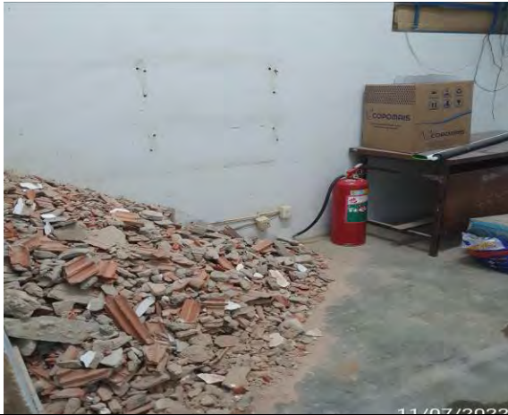
Foto 09: Vista de resíduos de construção dispostos de forma irregular.
