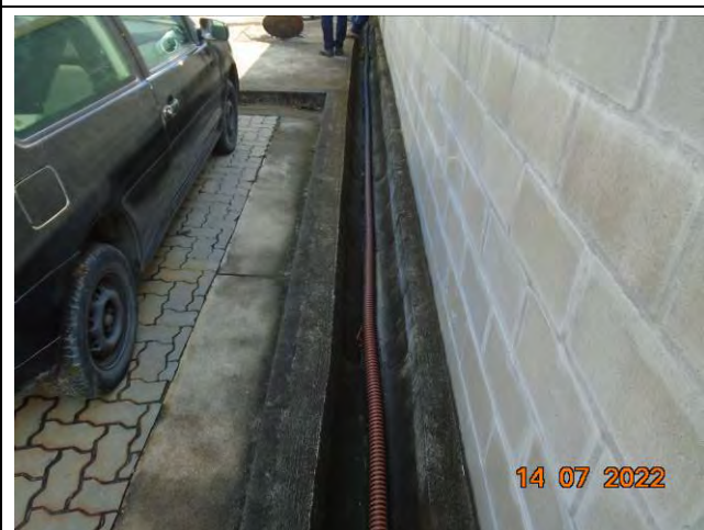
Foto 23: Detalhe do descarte dos efluentes gerados na ERES Taça diretamente na rede de esgoto.
