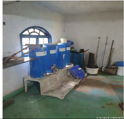
Foto 04: Vista da área de cloração. Nota-se que os materiais estão desorganizados e obsoletos.
