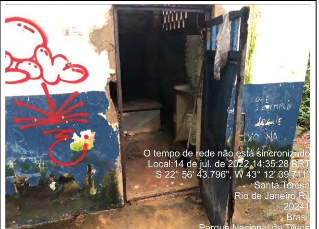
Foto 38: Vista da área de cloração da UT Paineiras. Nota-se que a estrutura necessita de manutenção.
