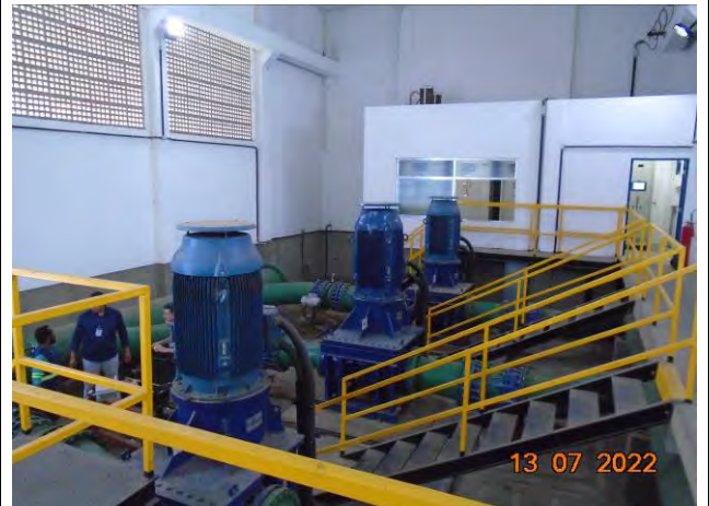
Foto 04: Conjunto de bombas – vista geral.
