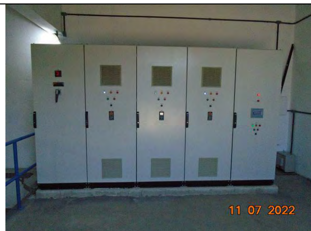
Foto 29: Painel casa de máquinas.
