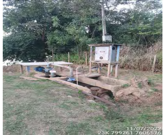
Foto 08: Vista das bombas da EEAB. Nota-se o desnível do terreno e estruturas obsoletas.
