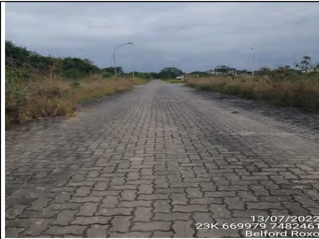
Foto 05: Registro da falta de capina na ETE.
