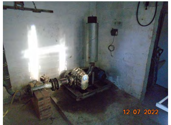
Foto 08: Detalhe de bomba instalada dentro da sala de análise. Detalhe para evidência de vazamento de óleo no local.
