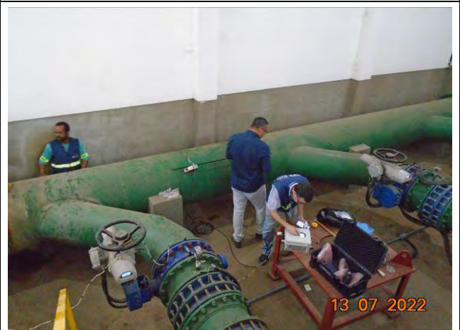
Foto 06: Equipe de manutenção eletromecânica – sem uso de EPI, no início da visita.
