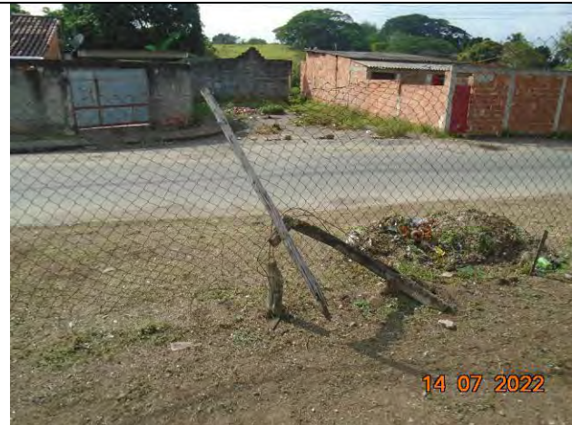
Foto 33: Cercamento deteriorado da área da Unidade.
