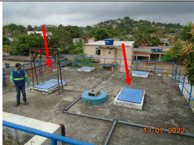
Foto 09: Caixas do sistema de batelada – apenas uma em funcionamento.
