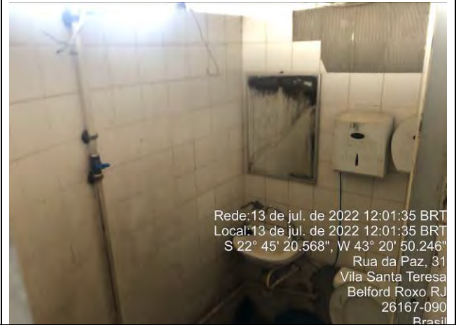
Foto 12: Registro do banheiro do vigilante. Nota-se material com mofo e falta de azulejo.
