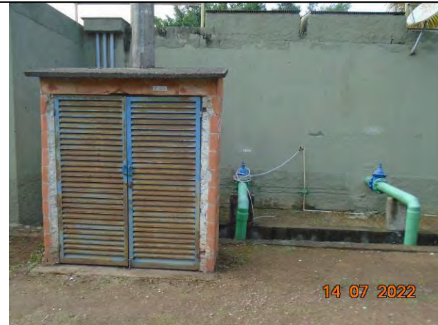
Foto 25: Caixa de força da Unidade.
