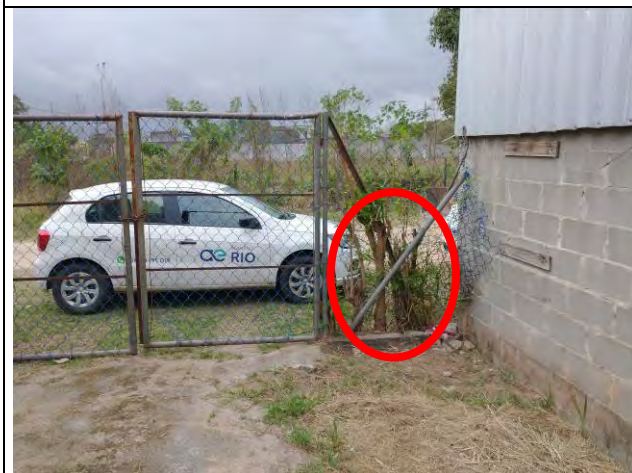
Foto 21: Área externa com cercamento danificado.
