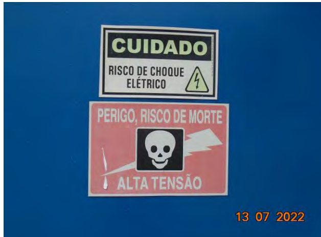
Foto 15: Sinalização da entrada da sala de força da EEAT Queimados.
