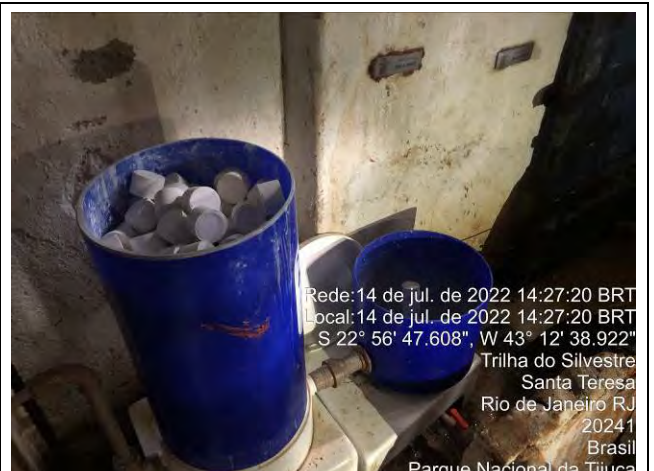
Foto 36: Registro dos cloros na área de cloração.
