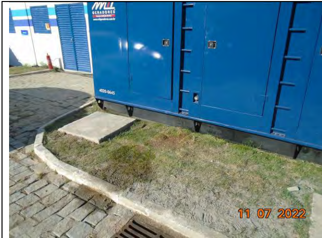
Foto 35: Evidência de vazamento de óleo ao lado de um dos geradores.
