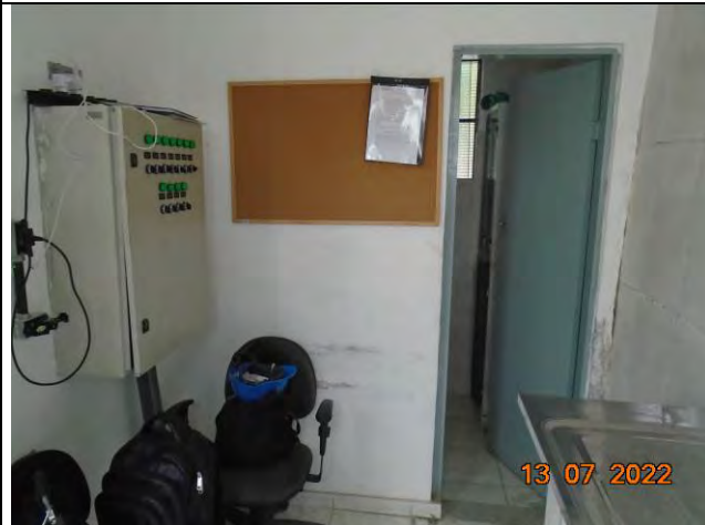
Foto 15: Caixa de força na área interna do prédio administrativo e quadro de aviso com a Licença de Instalação e Operação do Ativo.
