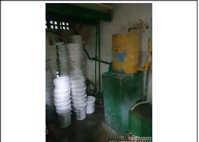
Foto 22: Vista geral dos recipientes vazios de cloro, armazenados de forma irregular.
