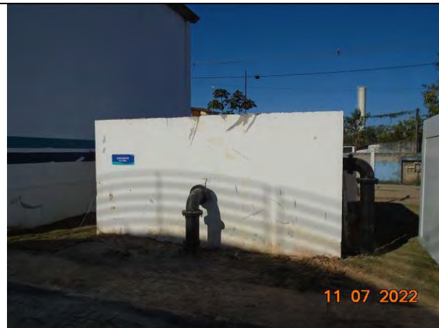
Foto 33: Instalações para adensamento de lodo residual do tratamento de água.
