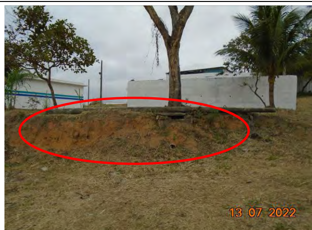
Foto 04: Área externa do prédio administrativo (área com barranco exposto).
