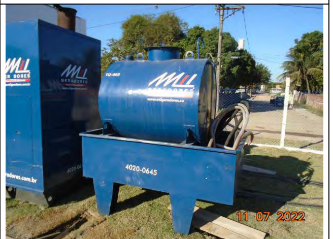
Foto 36: Tanque de combustível com óleo diesel que abastece um dos geradores.
