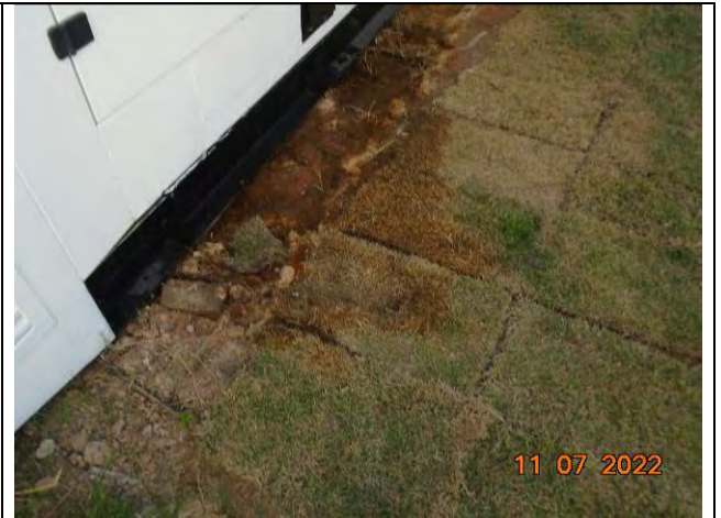
Foto 36: Evidência de vazamento de óleo ao lado de outro gerador.
