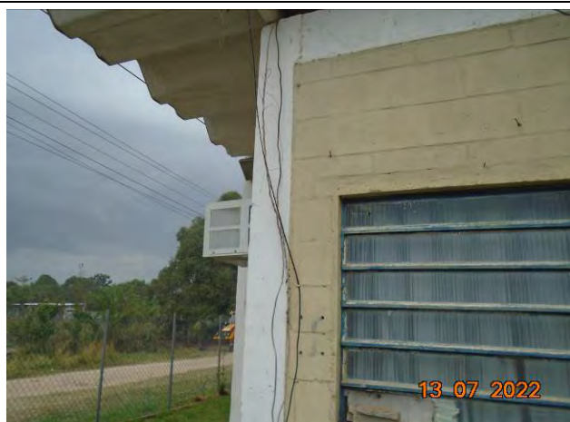
Foto 05: Fiação exposta e mau estado de conservação da janela da sala de bombas.
