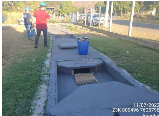
Foto 03: Detalhe da chegada do efluente na ETE.
