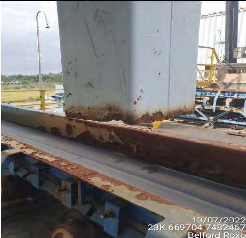
Foto 9: Registro dos equipamentos e da esteira na ETE necessitando de manutenção e obsoletas.
