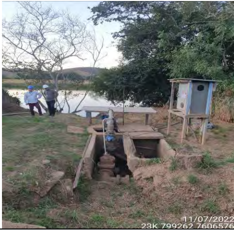
Foto 09: Vista das bombas da EEAB. Nota-se o desnível do terreno e estruturas obsoletas.
