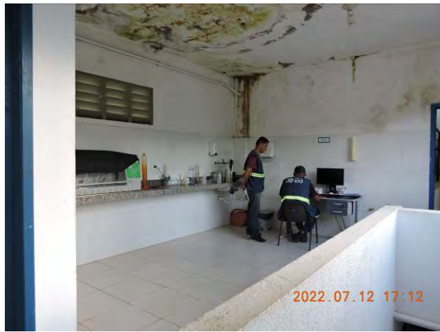
Foto 13: Vista geral do laboratório da ETA Caceribú. Nota-se a presença de mofo na parede superior e laterais do laboratório.
