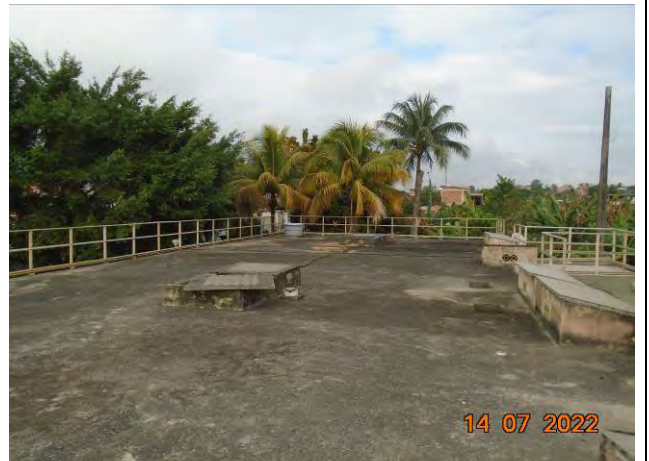
Foto 16: Vista geral do piso superior da ETE onde estão os aeradores e o sistema de decantação e secagem de lodo.
