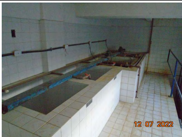
Foto 17: Tanques de fluoração.
