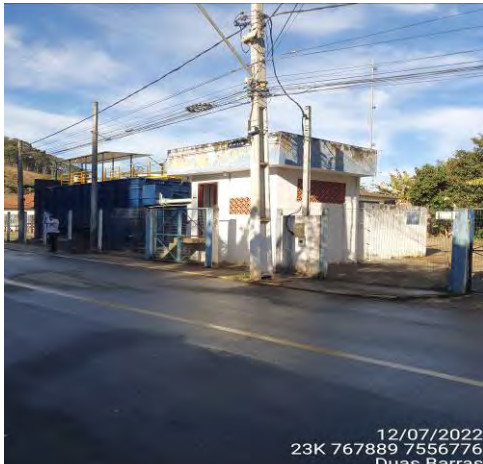
Foto 11: Vista geral da entrada da ETA Rio Macuco.
