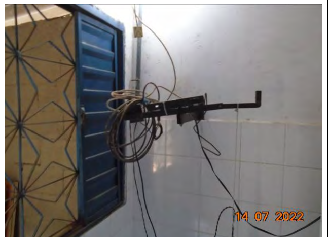
Foto 08: Fiação exposta e suporte de TV desativado.
