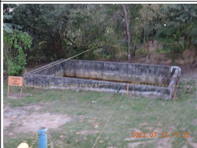
Foto 22: Vista geral do tanque de água de reúso. Nota-se a ausência de guarda-corpo nas laterais do tanque.
