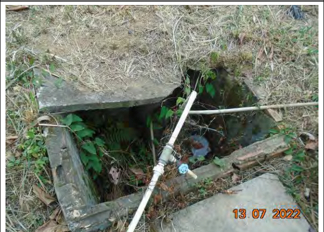
Foto 18: Caixa de registros danificada e sem sinalização adequada alertando para risco de quedas
