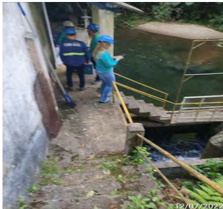
Foto 11: Vista da escada para acesso a EEAT, necessitando de manutenção.
