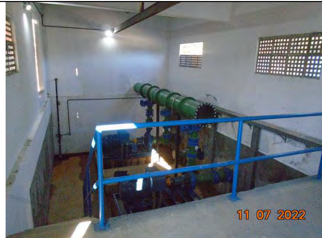
Foto 27: Casa de máquina - elevatória de água tratada.
