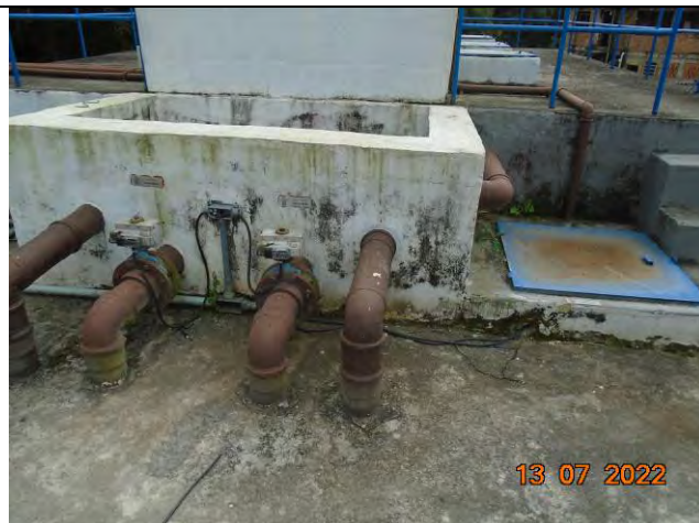
Foto 11: Fiação exposta e má conservação das estruturas.
