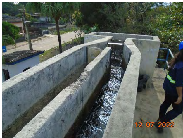
Foto 03: Medidor para controle de vazão da água que segue para o tratamento.
