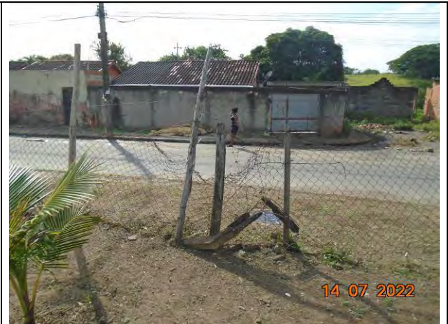
Foto 32: Cercamento deteriorado da área da Unidade.
