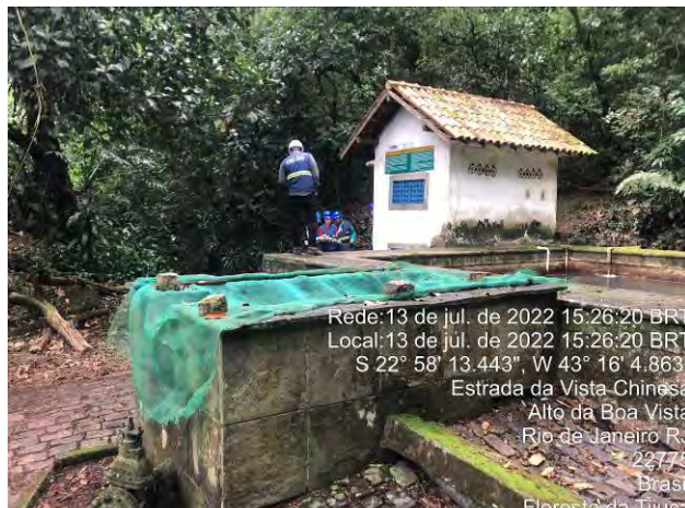
Foto 19: Vista da instalação da UT Gávea. Nota-se que a estrutura necessita de manutenção.
