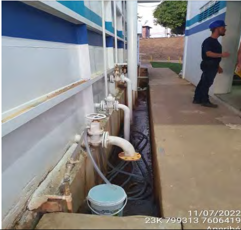
Foto 07: Vista da área sem guarda-corpo ou sinalização.
