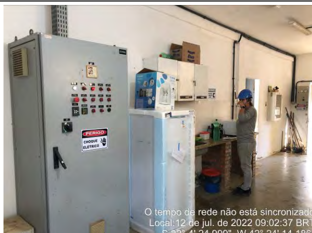
Foto 05: Vista da área de secagem do lodo. Nota-se a presença de materiais químicos espalhados.
