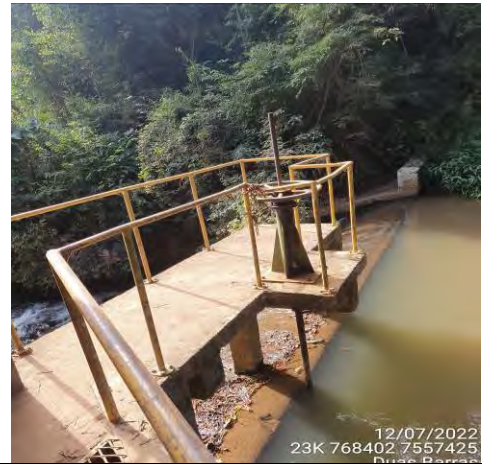
Foto 02: Vista do guarda-corpo, necessitando de reparos.
