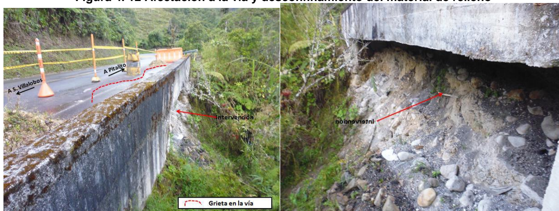
Figura 4. 12 Afectación a la vía y desconfinamiento del material de relleno
