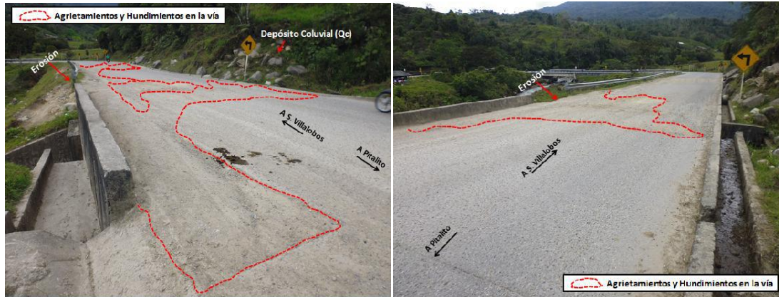
Figura 4. 17 Hundimiento de la banca de la vía
