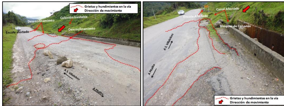
Figura 4. 15 Afectación de la banca de la vía
