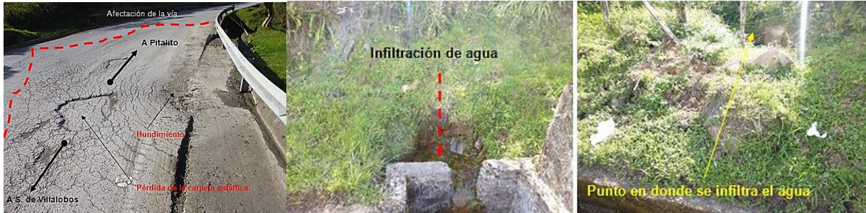
Figura 4. 18 Estado de la vía e infiltración de agua
