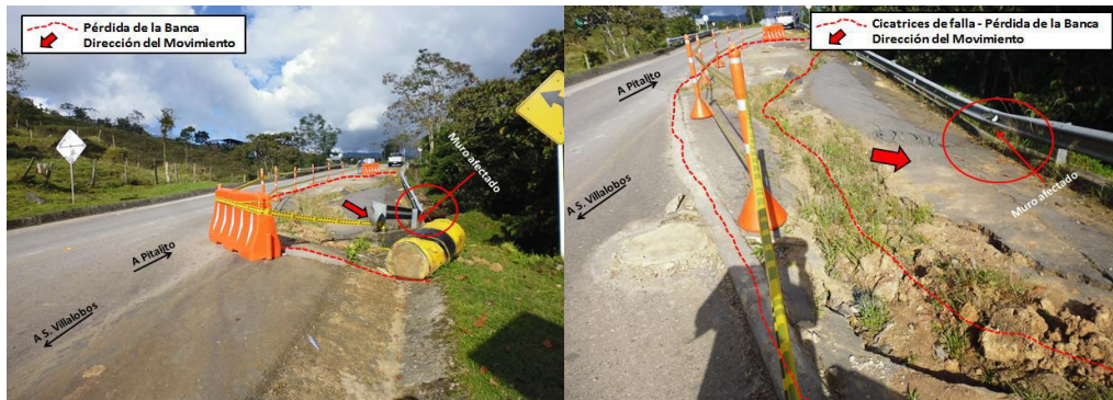
Figura 4. 13 Hundimiento de la banca de la vía
