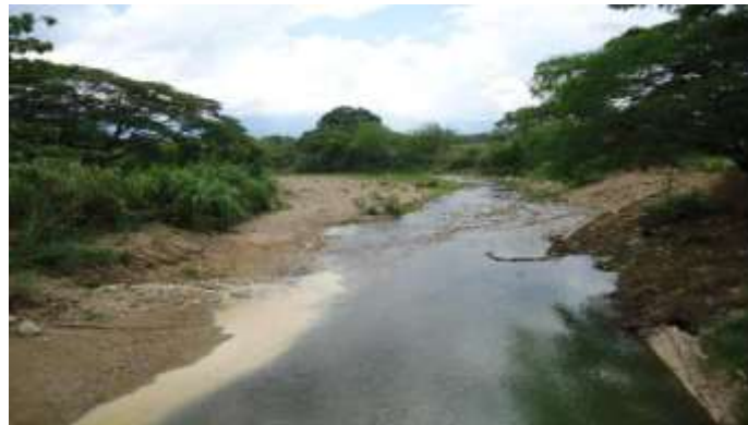
Figura 5-11: Afectación por erosión por socavación
