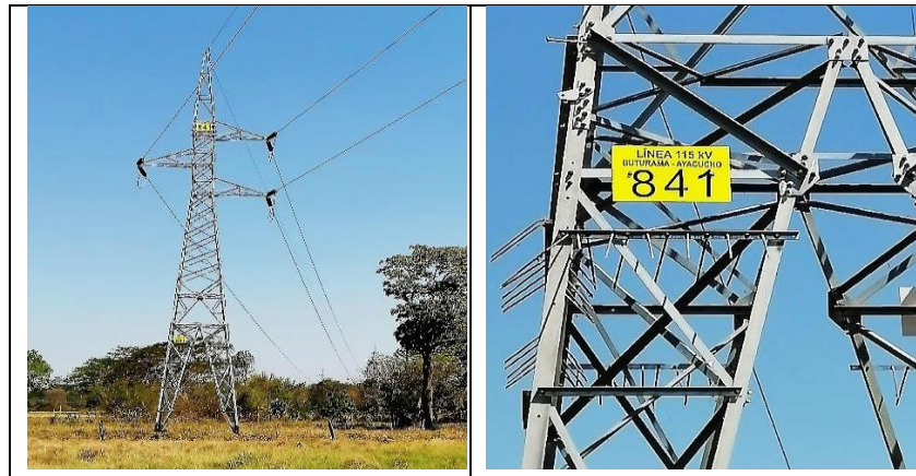
Figura 15. Redes Eléctricas de Alta tensión Buturama – Ayacucho -115 kv.
