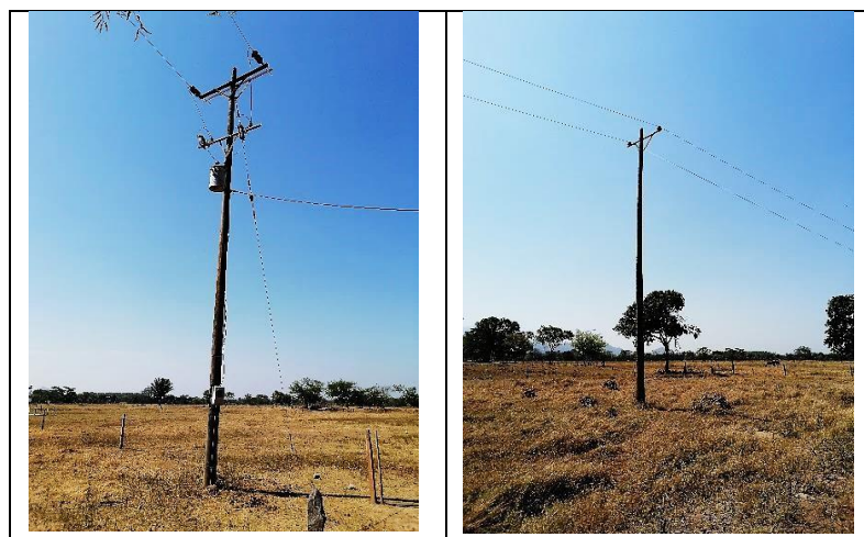
Figura 16. Redes Eléctricas de Media Tensión.
