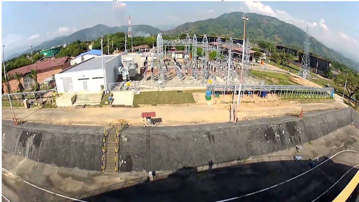
Figura 12. Subestación eléctrica Ayacucho.
