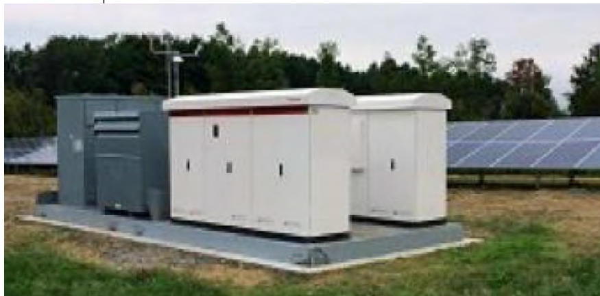
Figura 39. Sala Eléctrica tipo SKID
