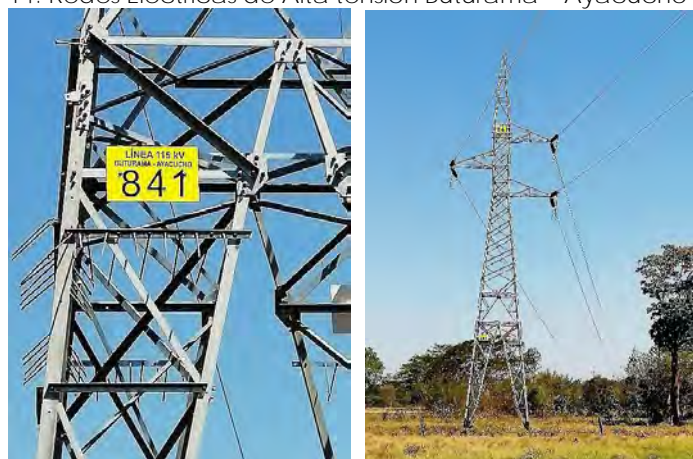
Figura 14. Redes Eléctricas de Alta tensión Buturama – Ayacucho -115 kv.
