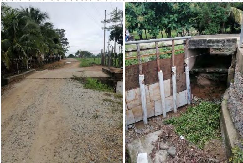
Figura 60. Puente sobre la vía de acceso a existente que requiere intervención
