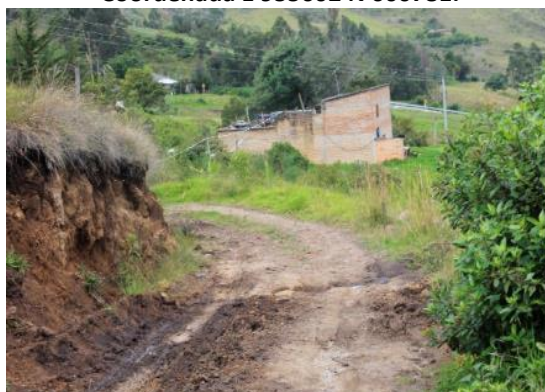
Fotografía 3.71 PK0+110. Tramo de la vía de acceso a la finca El tesoro. Coordenada E 955602 N 600781.
