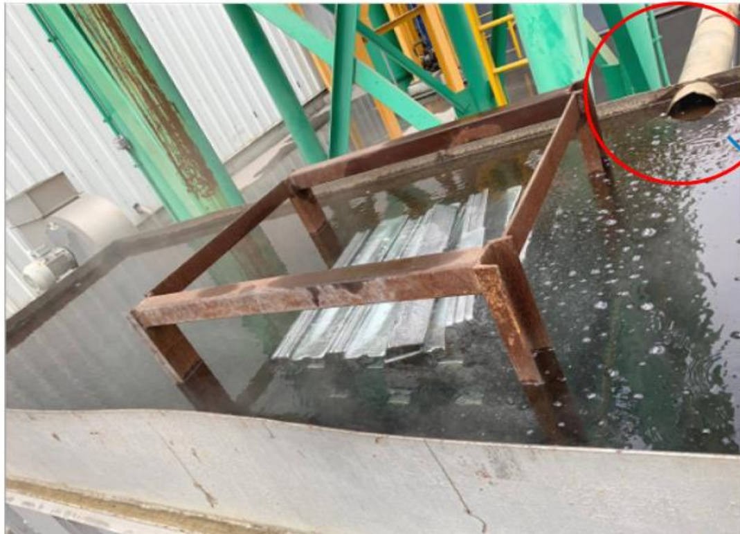
Figura II.30 Infraestructura de torre de enfriamiento (recirculación de agua)
