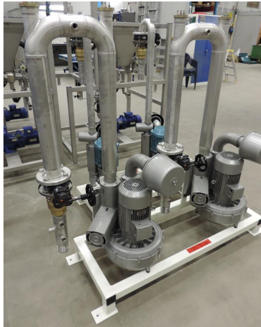
Figura II—59. Ventilador de aire de transporte para los aditivos.
