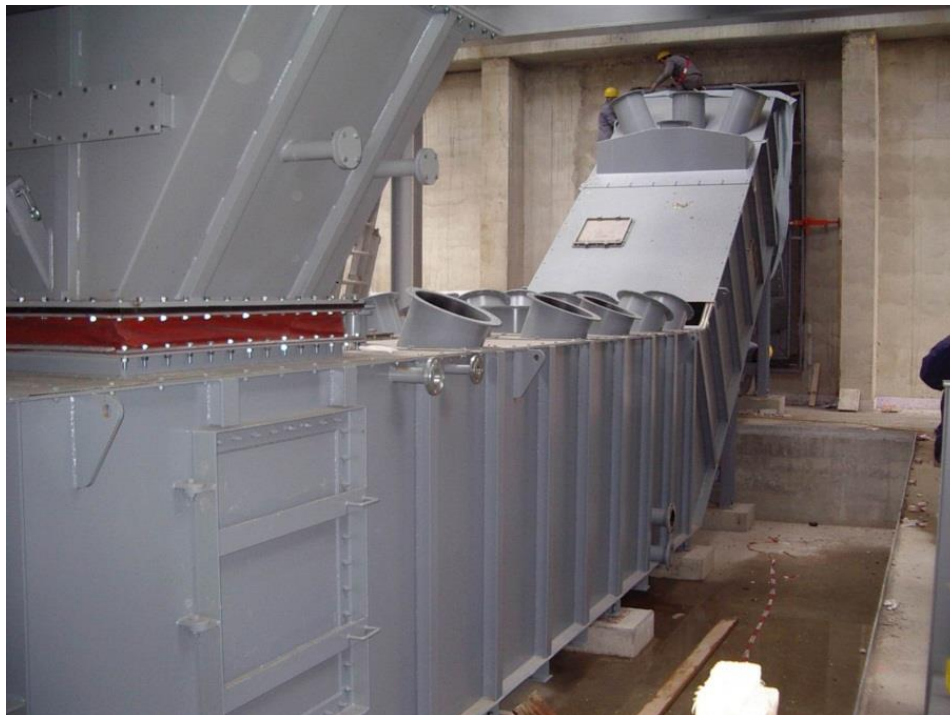
Figura II—37. Extractor de escoria tipo cinta de placas.
