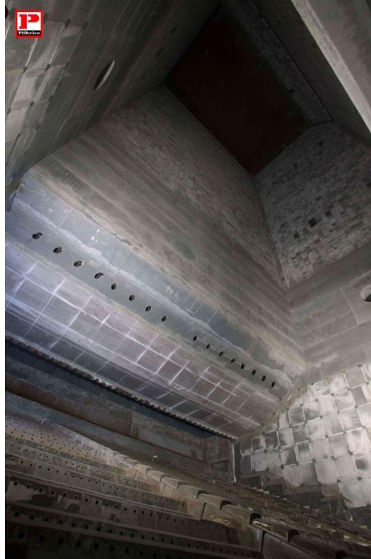
Figura II—51. Revestimiento refractario en la cámara de combustión y en el primer paso de la caldera.
