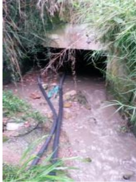
Fotografía 4. Qda. Agua de Panela Aguas Abajo
