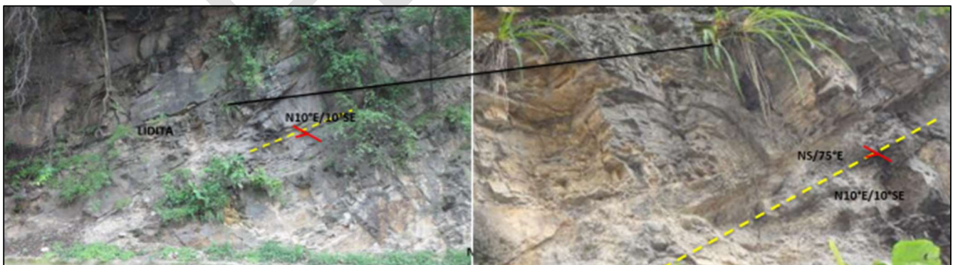
Fotografía 25 Túnel Palmichala. Areniscas y liditas fracturadas localmente presentan truncamiento y plegamiento de los niveles.
