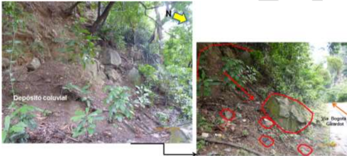
Fotografía 36 Proceso de remoción en masa de tipo Caídas de bloques y rodamiento de materiales., evidenciado sobre la Vía Bogotá – Girardot
