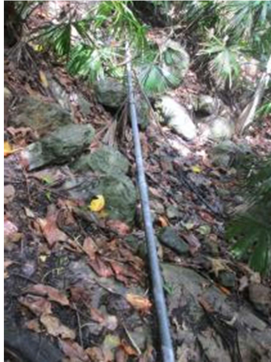
Fotografía 75 Tubería que conduce agua del manantial al tanque de almacenamiento – Finca Serranías del Sumapaz
