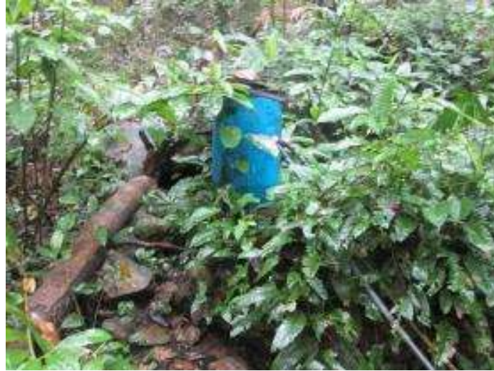
Fotografía 79 Tanques de Almacenamiento de agua - Finca La Selva
