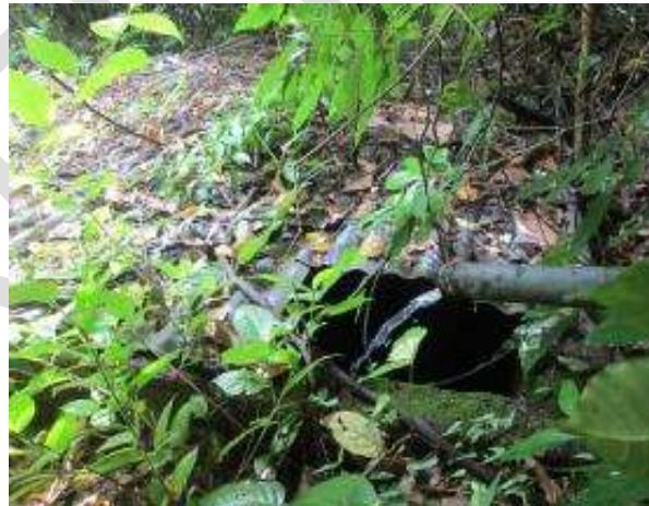
Fotografía 76 Tubería llegando al tanque de almacenamiento – Finca Serranías del Sumapaz
