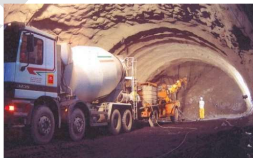
Figura 22. Equipo de hormigonado
