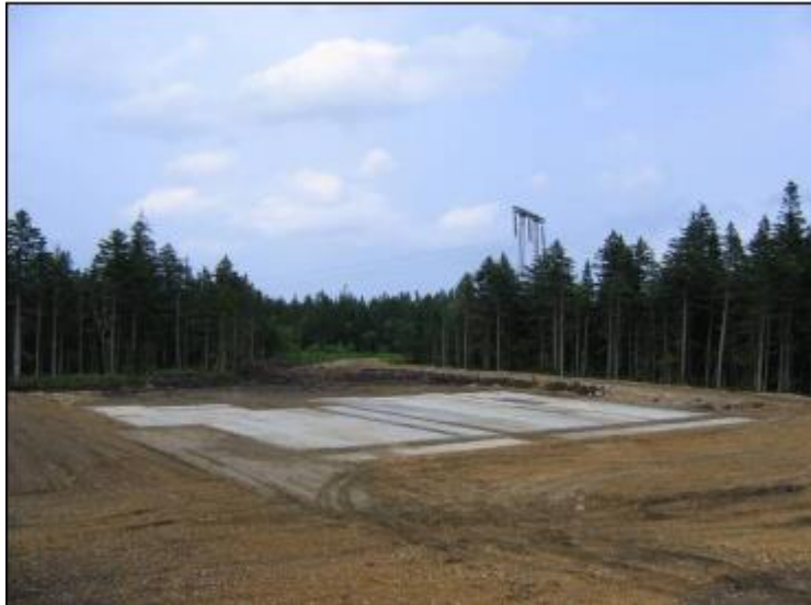
Figura 1-24 - Ejemplo de base para plataforma HDD con relleno de grava y losas de concreto
