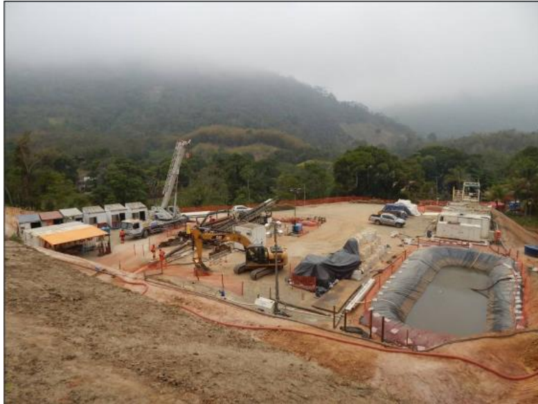
Figura 1-28 - Distribución de equipamiento HDD – Serra de Inoa
