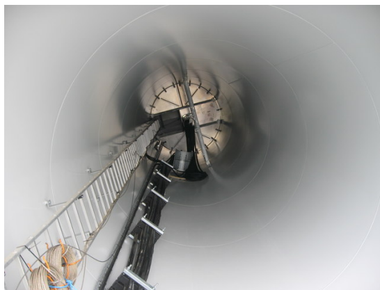
Foto 2.b-3: Interior de uma torre eólica
