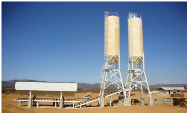
Foto 2.b-13: Exemplo de Usina de Concreto. Parque Eólico Desenvix – BA.
