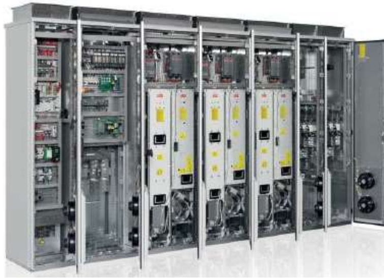
Figura 7. Interior de un inversor fotovoltaico
