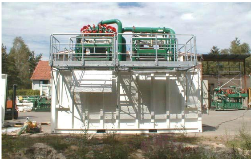
Figura 3-8 - Sistema de Reciclaje- Copyright © DERRICK
