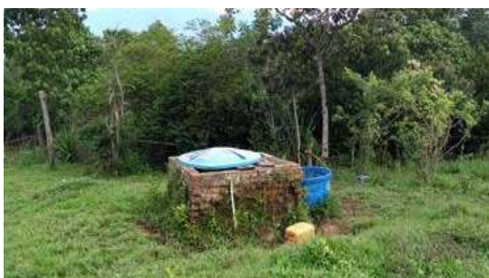
Fotografía 3.37 Sistema de almacenamiento de agua
