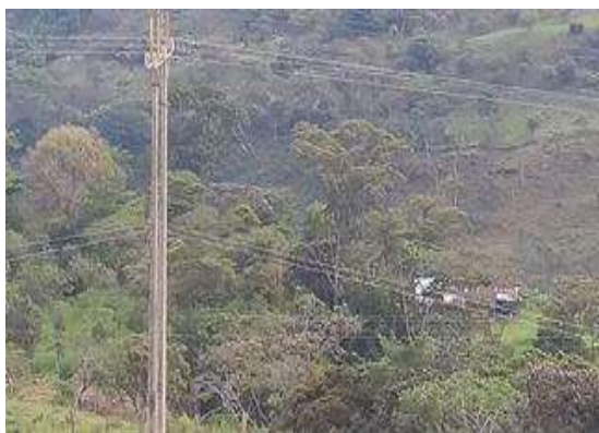
Fotografía 3.40 Conexión al servicio de energía en la vereda La Bejuca
