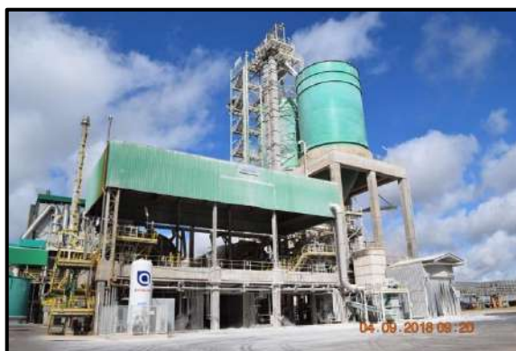
Figura 18 - Forno de cal instalado.
