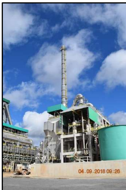
Figura 15 - Caldeira de recuperação existente.
