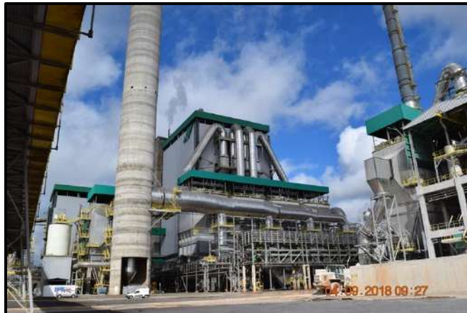
Figura 8 - Caldeira de biomassa implantada.
