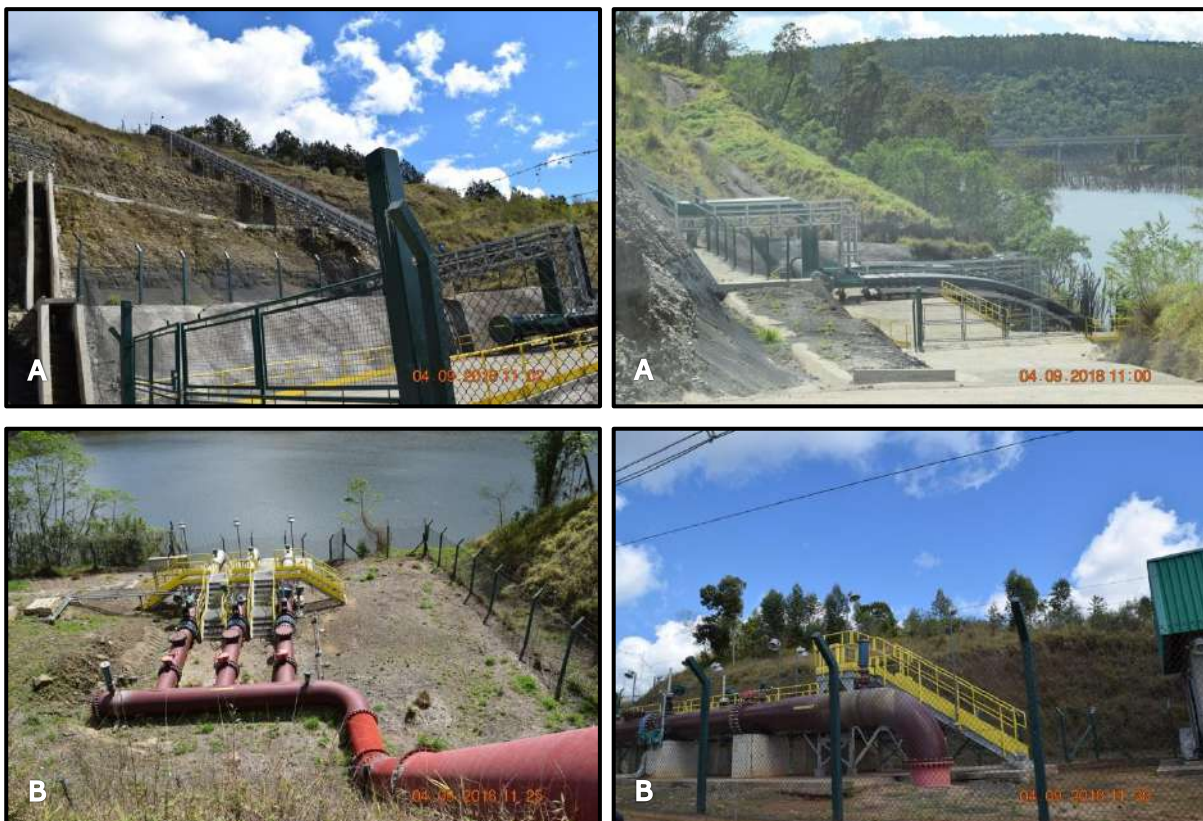
Figura 71 – Estruturas de captação de água (A) e do emissário (B).
